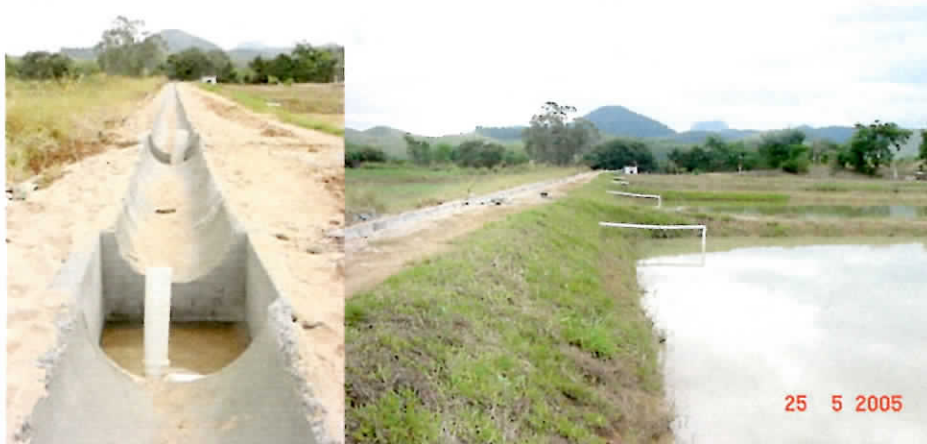
Figura 14: Canal de Abastecimento. Figura 16: Tanques sendo abastecidos.
