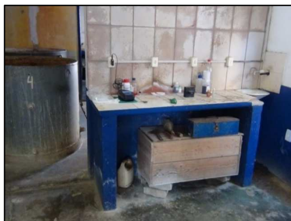
Figura 19 – Equipamentos de medição - ETA Centro
