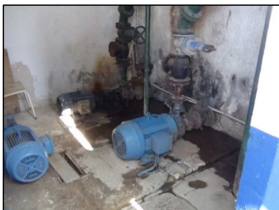
Figura 18 – Sistema de bombeamento - ETA Centro
