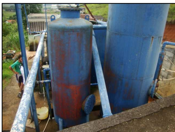
Figura 26 – Vista da ETA Bulhões
