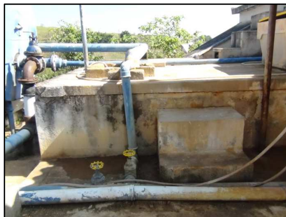
Figura 29 – Reservatório - ETA Bulhões
