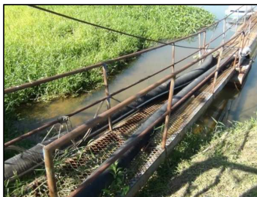
Figura 11 – Tubulação para condução da água captada
