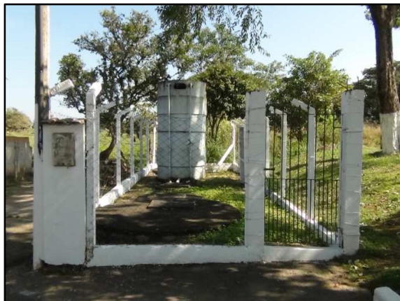
Figura 37 – Sistema de tratamento a nível secundário - Vila Santo Antônio
