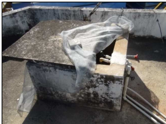
Figura 16 – Adição de cloro no reservatório – ETA Centro
