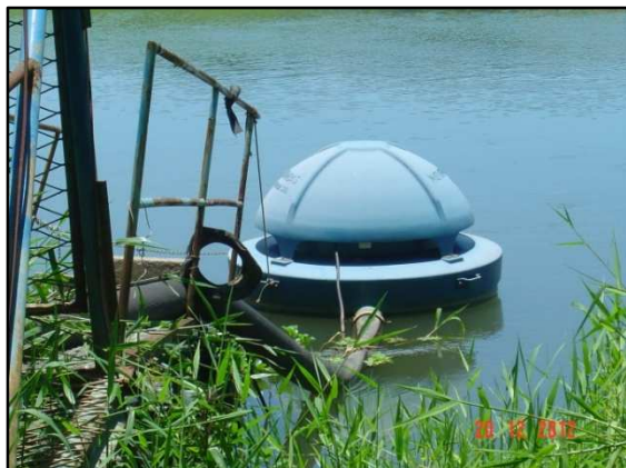
Figura 8 – Captação da ETA Centro
