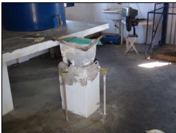
Figura 22 – Tratamento com cloro - ETA Freitas Soares
