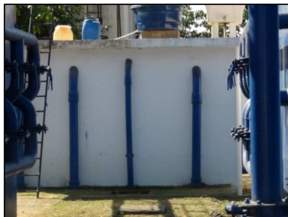
Figura 23 – Reservatório - ETA Freitas Soares
