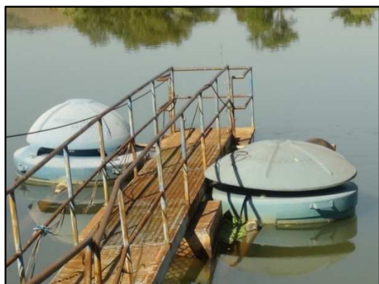
Figura 10 – Captação ETA Freitas Soares
