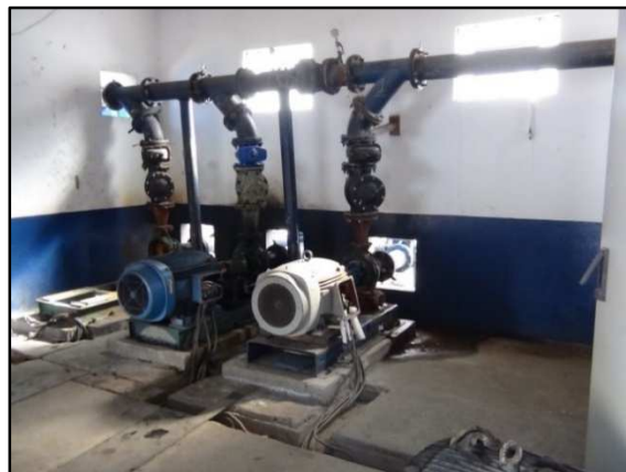
Figura 25 – Sistema de bombeamento - ETA Freitas Soares
