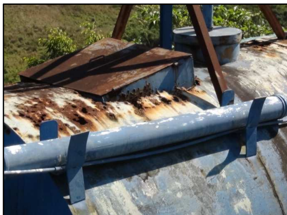
Figura 28 – Condições desfavoráveis - ETA Bulhões
