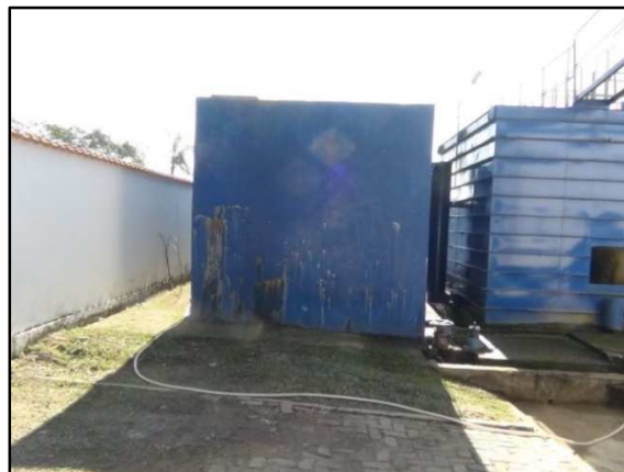
Figura 17 – Vista dos reservatórios - ETA Centro
