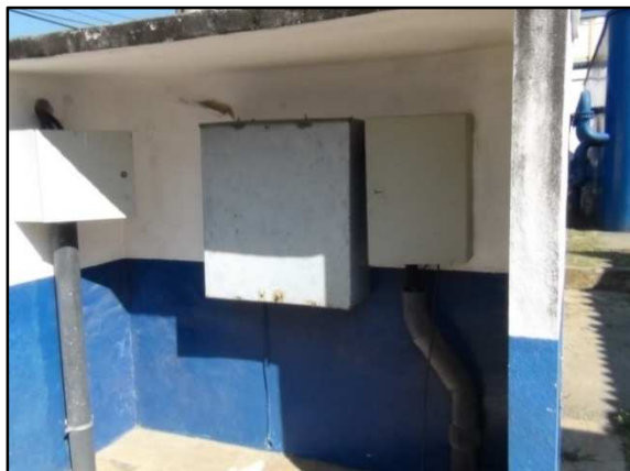
Figura 24 – Casa de bomba - ETA Freitas Soares
