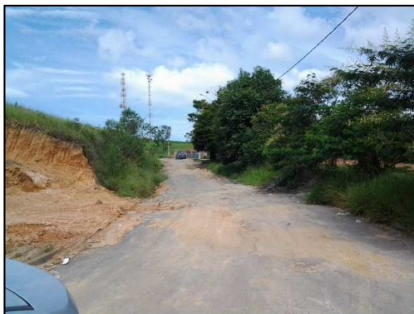
Figura 39 – Rua com sinais de carreamento de solo pela falta de drenagem
