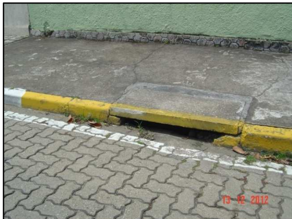
Figura 40 – Boca de lobo
