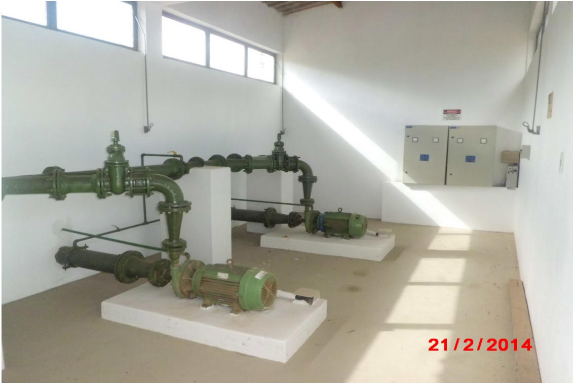
Figura 13: Estação Elevatória de Água Bruta - EEAB. UTM – 705112/7676682.
