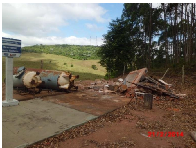
Figura 24: Antiga ETA desativada e em desmonte Fonte Conen
