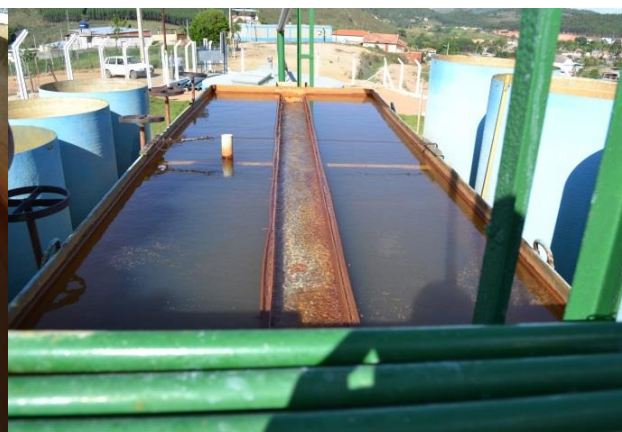
Figura 17: ETA flocculador Fonte Conen
