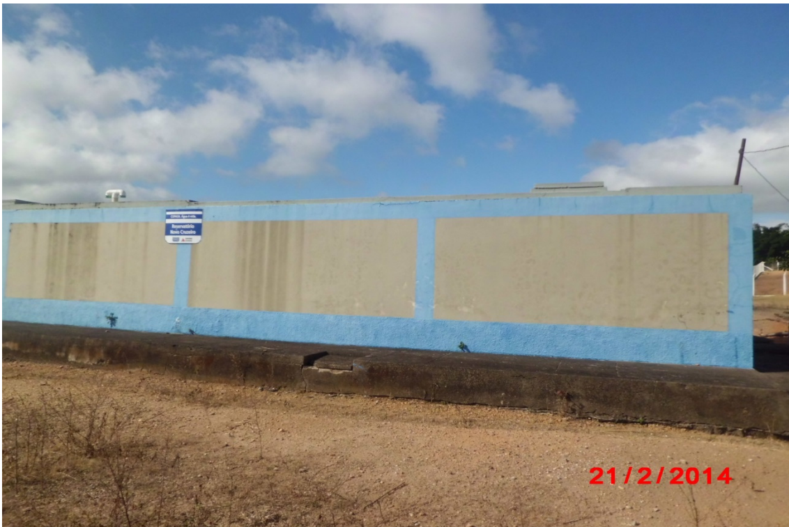
Figura 12: Reservatório Principal. UTM – 706992/7677533.
