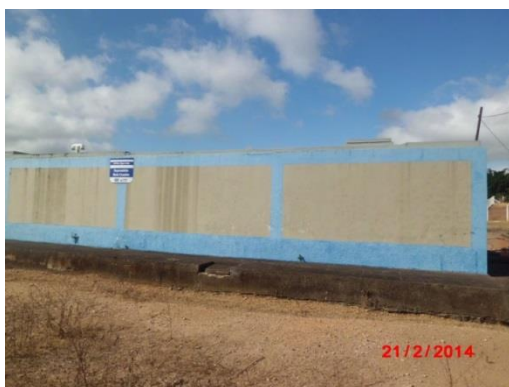
Figura 20: Reservatório Principal R-01 Fonte Conen
