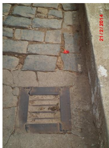
Figura 38: Identificação de ralo bloqueado na Sede Municipal Fonte Conen
