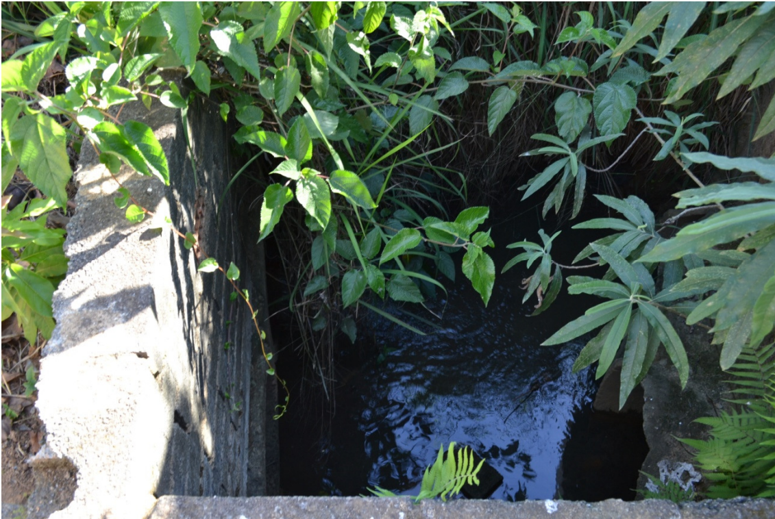
Figura 9: Lançamento de esgoto no córrego. UTM – 707087/7677825.
