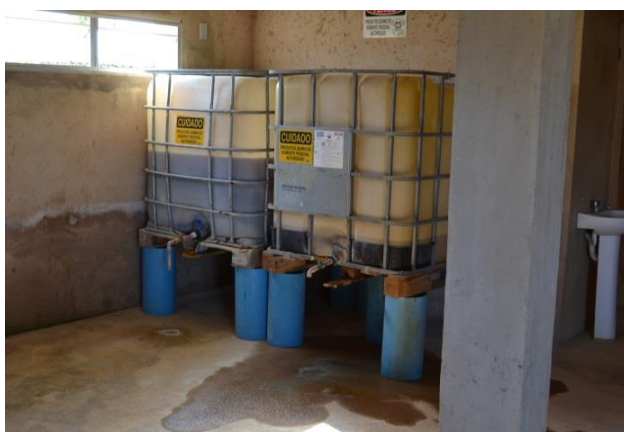
Figura 10: ETA – armazenagem de produto químico Fonte Conen
