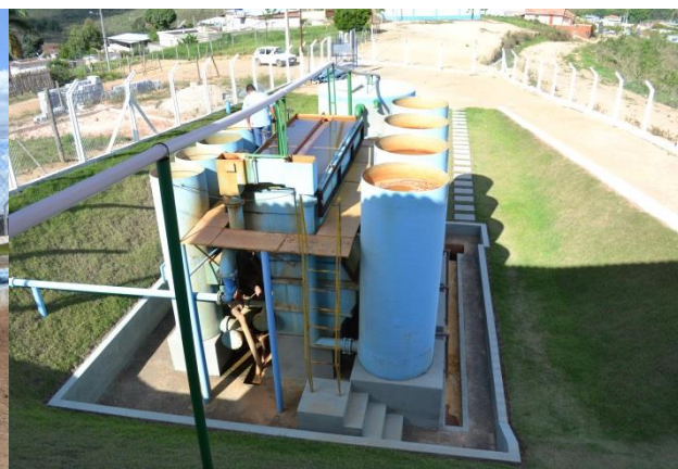
Figura 9: ETA instalações de produção Fonte Conen
