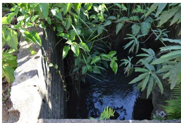
Figura 28: Lançamento de esgoto no córrego Fonte Conen
