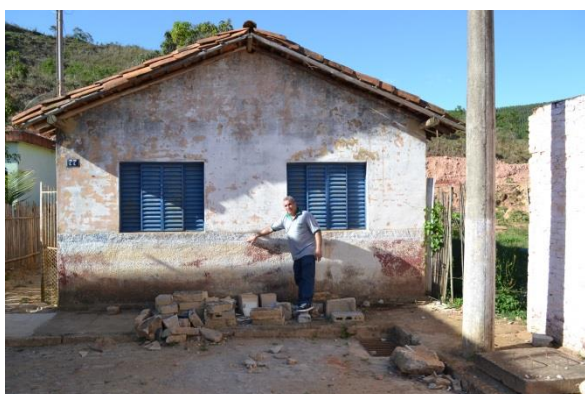
Figura 42: Indicação de marcas causadas por alagamentos em residência no Município de Divinésia Fonte Conen
