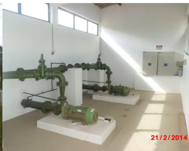
Figura 6: Bombas da EAB Fonte Conen
