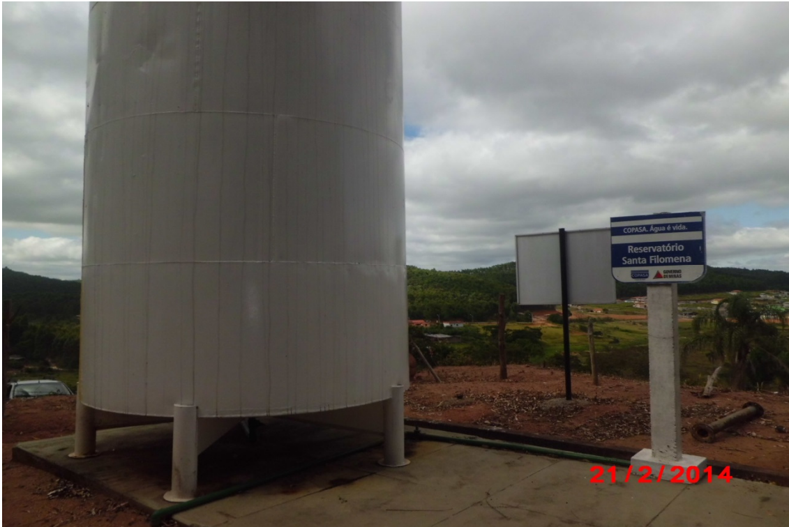
Figura 15: Reservatório Santa Filomena. UTM – 708600/7678191.
