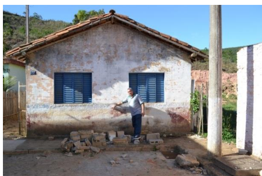
Figura 38: Indicação de marcas causadas por alagamentos em residência no Município de Divinésia Fonte: Conen
