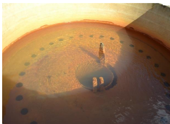
Figura 20: ETA - Filtros. Fonte: Conen
