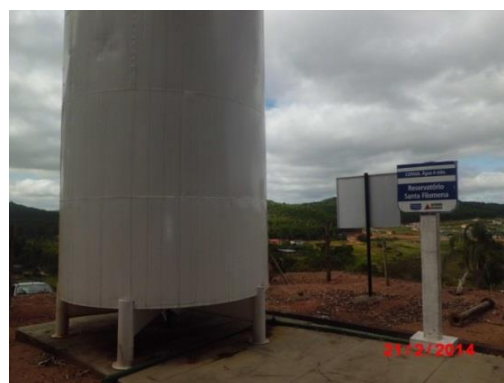
Figura 23: Reservatório Santa Filomena R-02 Fonte: Conen
