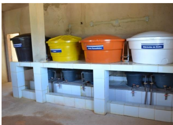
Figura 19: Dosagem de produtos químicos. Fonte: Conen
