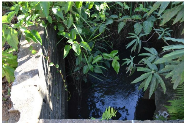
Figura 28: Lançamento de esgoto no córrego. Fonte: Conen
