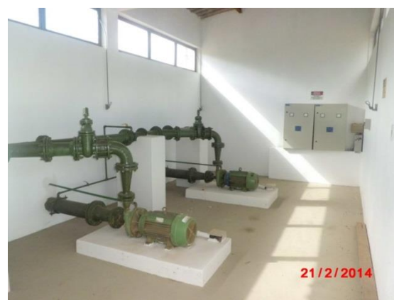
Figura 16: Bombas da EAB Fonte: Conen
