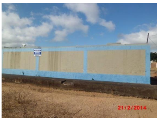
Figura 22: Reservatório principal R-01 Fonte: Conen
