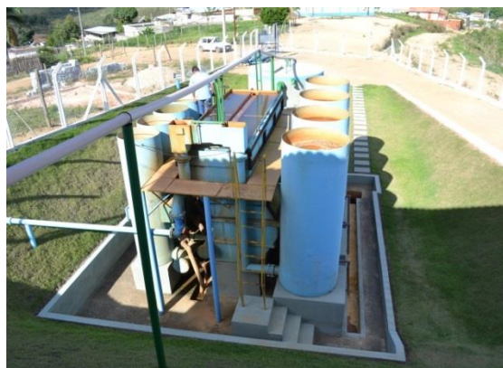
Figura 18: ETA instalações de produção Fonte: Conen
