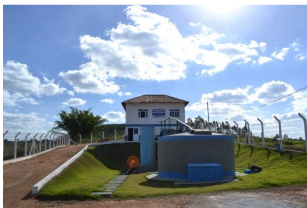
Figura 21: Tanque de contato Fonte: Conen
