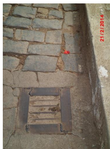
Figura 36: Identificação de ralo bloqueado na Sede Municipal Fonte: Conen
