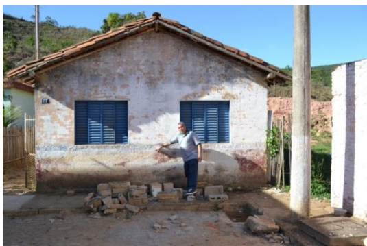
Figura 38: Indicação de marcas causadas por alagamentos em residência no Município de Divinésia Fonte: Conen
