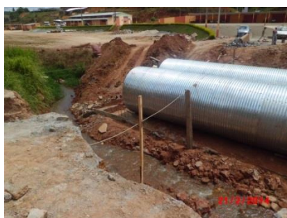
Figura 40: Identificação de estrutura a ser utilizada na retificação de rios Fonte: Conen
