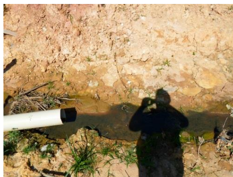
Figura 39: Lançamento de esgoto in natura em córrego Fonte: Conen
