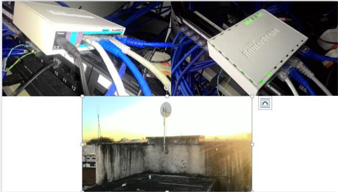
Figura 3 – Equipamentos da internet via rádio instalados na sede da AGEVAP
