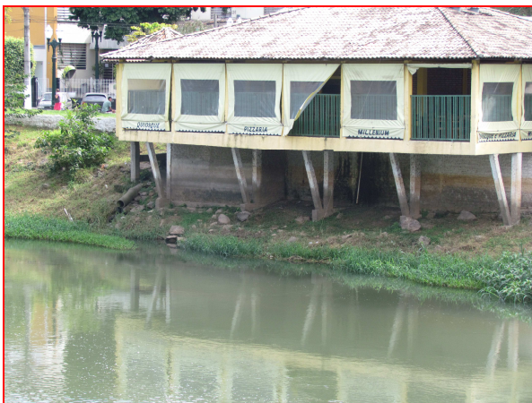
Foto 25: Construção irregular a margem do rio na cidade de Queluz – SP.
