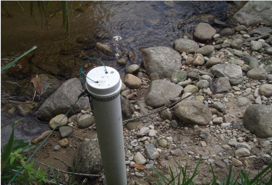
Figura 87. Sensor de Nível na Ponte do Gonzalo
