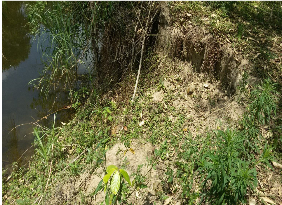
Figura 67. Erosão em APP do Rio das Pedras - Sítio Barreiros
