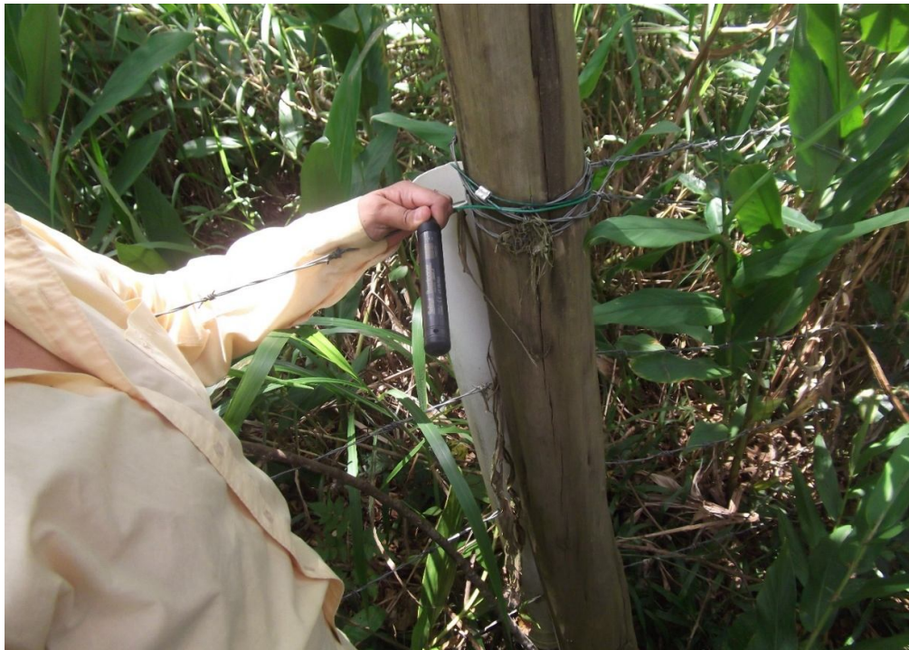
Figura 88. Sensor Barométrico na Ponte do Gonzalo
