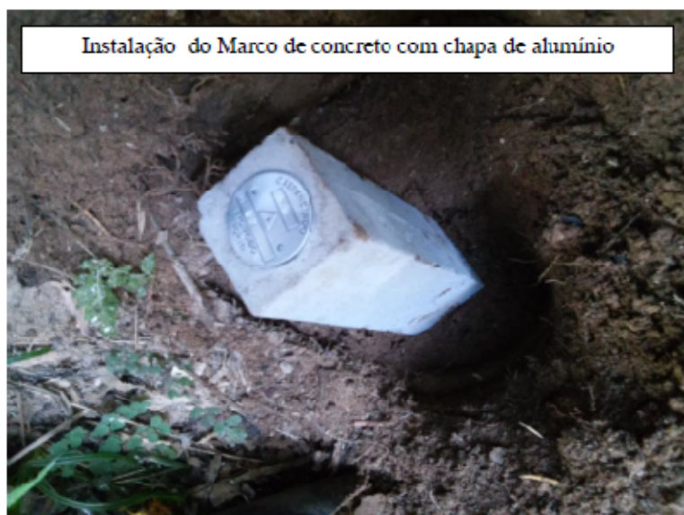
Figura 8 – Marco de concreto com chapa de alumínio instalado nos pontos finais de cada seção (RN02).
