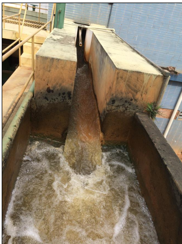
Figura 32 – Calha Parschall – Distrito Sede Fonte: DRZ - Gestão Ambiental
