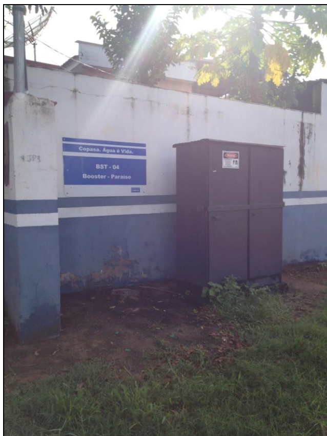
Figura 22 – Booster 4 – Distrito Sede Fonte: DRZ – Gestão Ambiental
