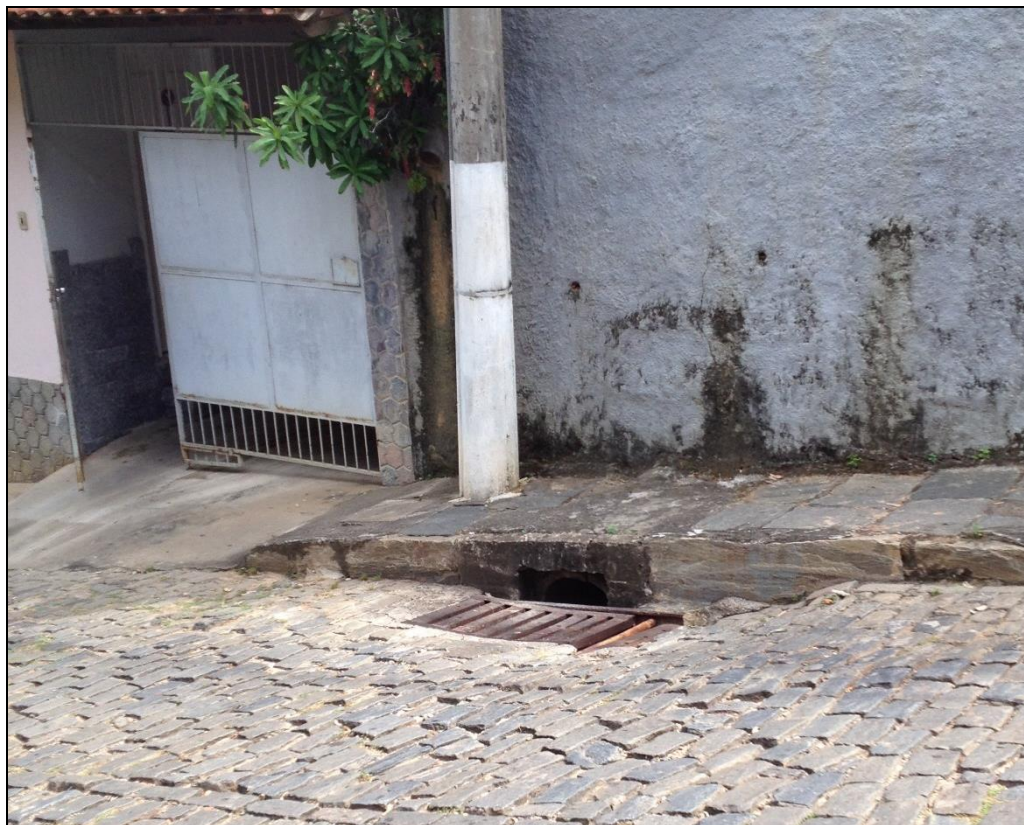
Figura 60 – Estrutura de captação do tipo combinada – Distrito Sede
