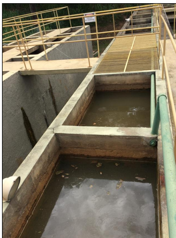
Figura 33 – Floculador – Distrito Sede Fonte: DRZ - Gestão Ambiental
