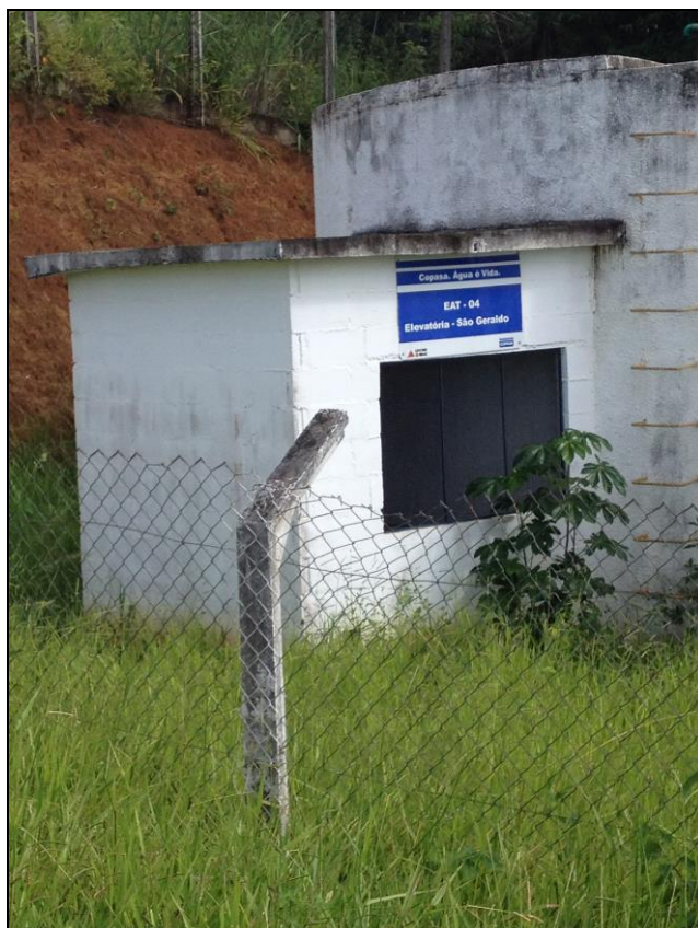
Figura 17 - Estação elevatória 4 – Distrito Sede Fonte: DRZ - Gestão Ambiental
