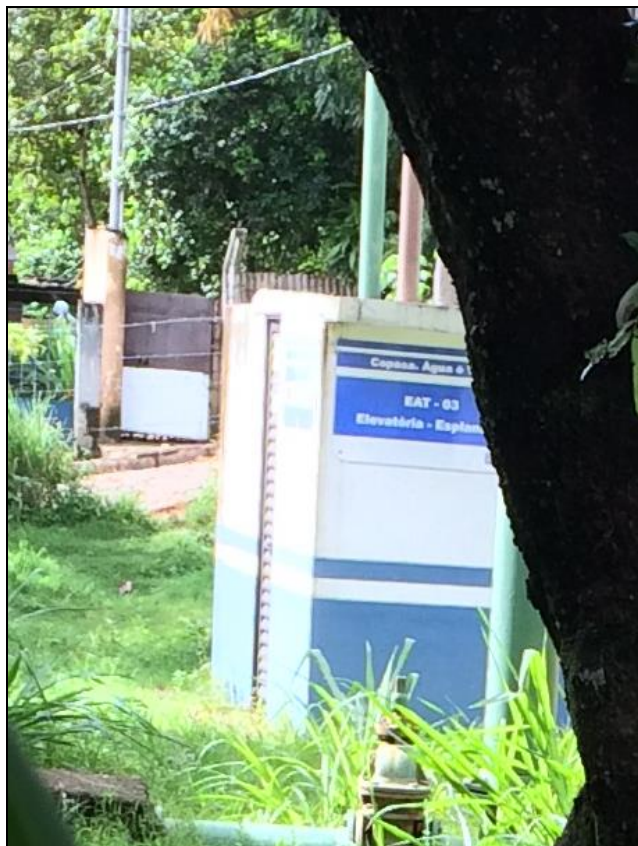
Figura 16 - Estação elevatória 3 – Distrito Sede Fonte: DRZ - Gestão Ambiental
