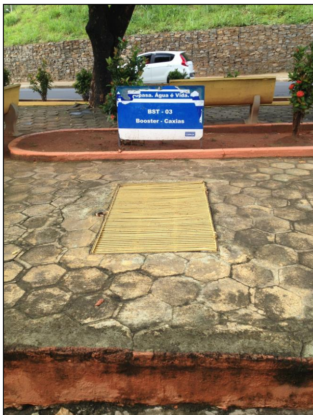
Figura 21 – Booster 3 – Distrito Sede Fonte: DRZ - Gestão Ambiental
