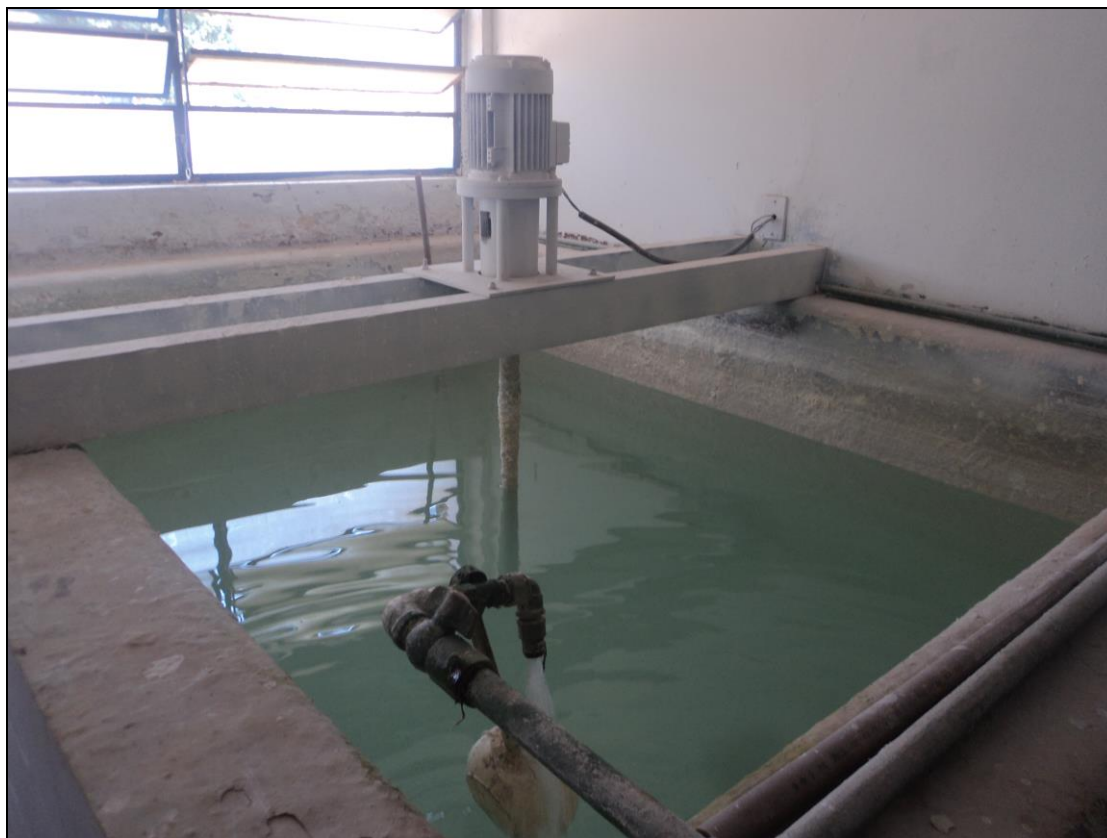
Figura 37 – Tanque misturador e agitador de sulfato de alumínio na água – Distrito Sede Fonte: DRZ - Gestão Ambiental
