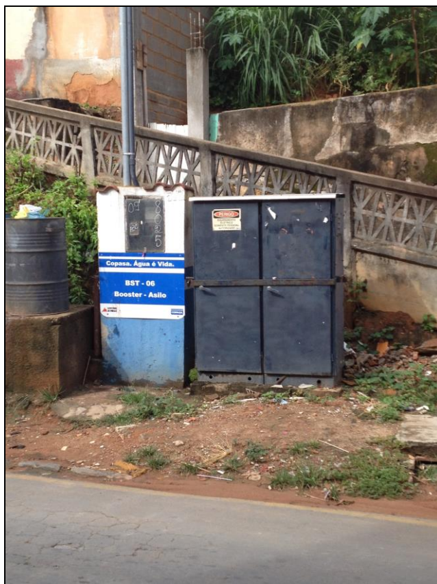
Figura 24 – Booster 6 – Distrito Sede Fonte: DRZ - Gestão Ambiental
