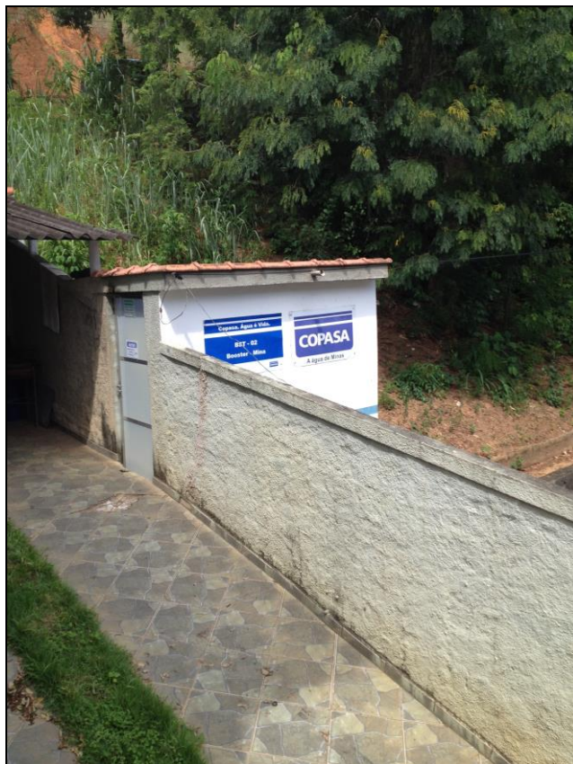
Figura 20 – Booster 2 – Distrito Sede Fonte: DRZ - Gestão Ambiental
