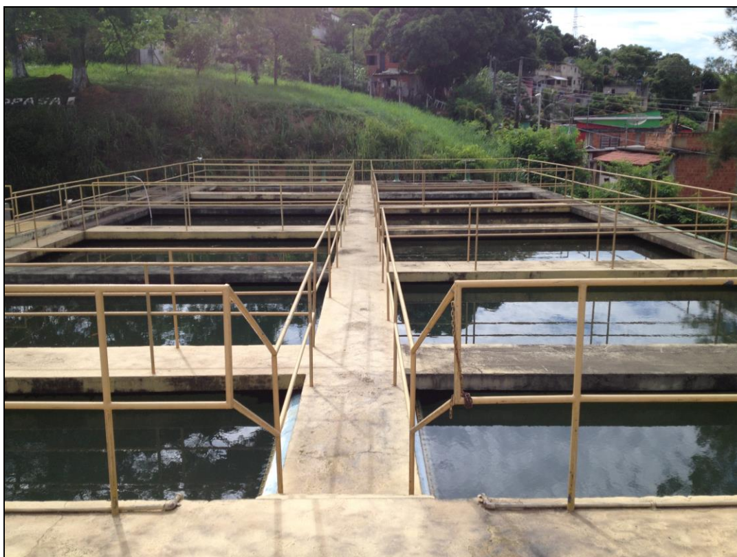
Figura 34 – Decantador – Distrito Sede Fonte: DRZ - Gestão Ambiental
