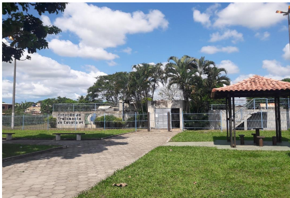
Figura 30. Vista geral da Estação de Tratamento de Esgoto do Centro. Fonte: Equipe Técnica (2019).
