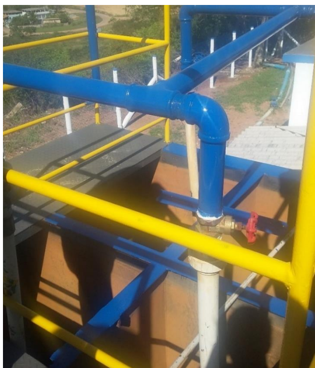
Figura 17. Filtro – ETA de Carapebus/RJ. Fonte: Equipe Técnica (2019).
