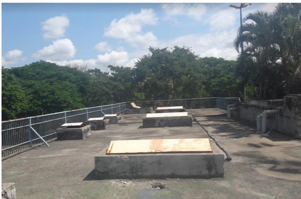
Figura 32. Presença de Ferrugem nas tampas dos tanques e deterioração do concreto na ETE do Centro de Carapebus,RJ. Fonte: Equipe técnica (2019).
