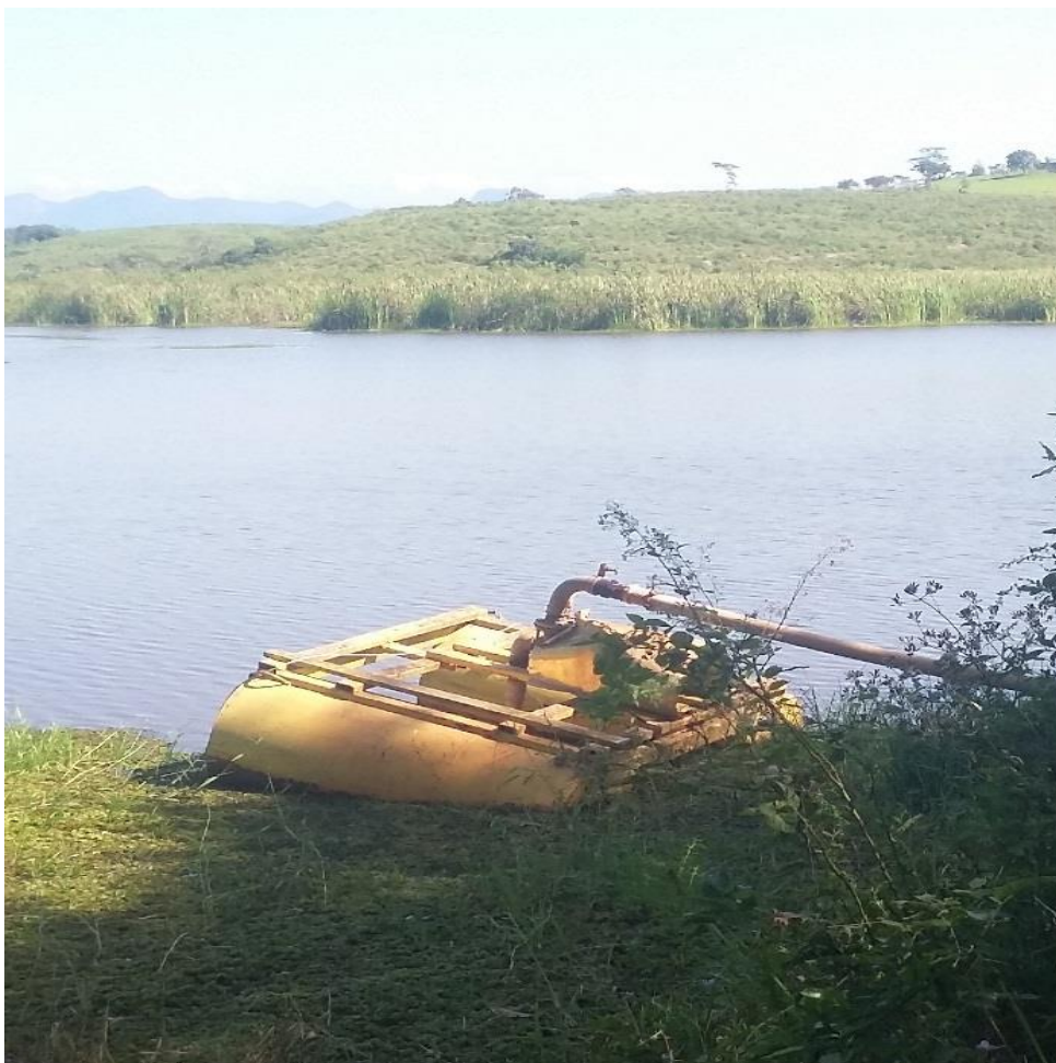
Figura 8. Bomba de captação de água da represa da Maricota. Fonte: Equipe Técnica (2019).
