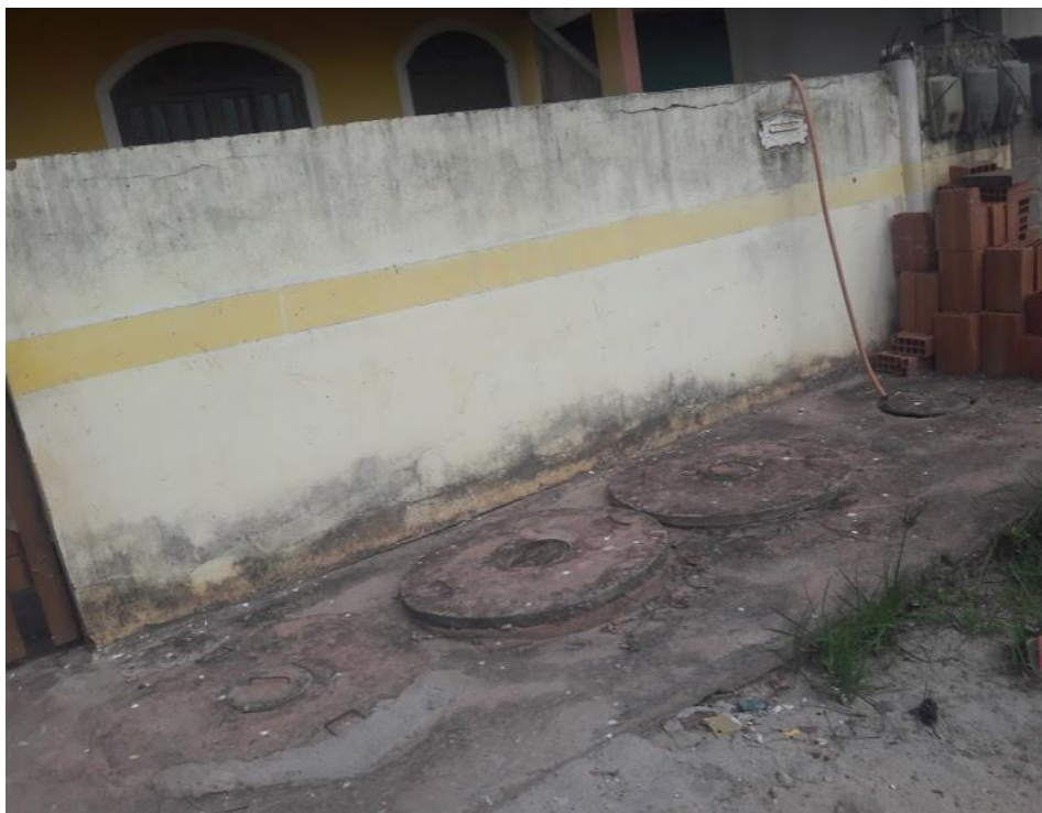
Figura 40. Residência do bairro Praia com sistema individual fossa filtro. Fonte: Equipe Técnica (2019).
