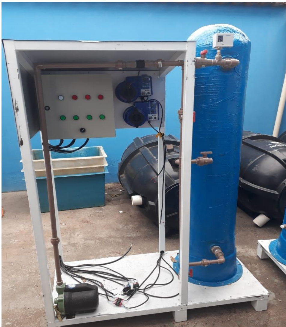
Figura 21. Estação de Tratamento de Água. ETA – Zeólita. Fonte: Equipe Técnica (2019).
