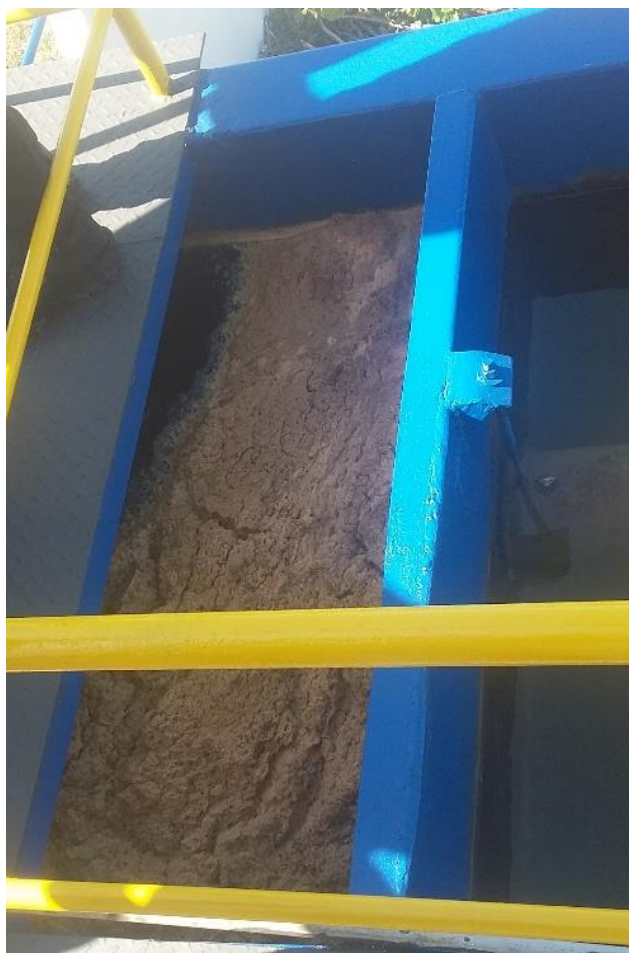
Figura 15. Processo de Flocculação – ETA de Carapebus/RJ. Fonte: Equipe Técnica (2019).
