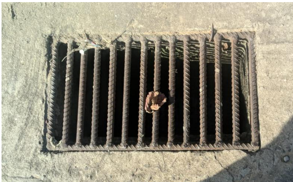
Figura 63. Estrutura do tipo grelha para captação de águas pluviais no município de Carapebus/RJ. Fonte: Comitê Executivo (2019).
