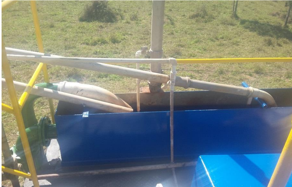
Figura 14. Calha Parshall – ETA de Carapebus/RJ. Fonte: Equipe Técnica (2019).
