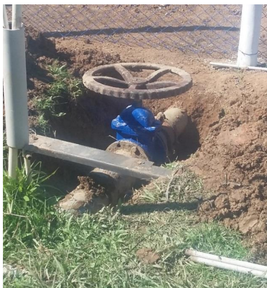
Figura 19. Registro responsável pelo sistema de manobra do bairro Centro a partir da ETA (em manutenção).
