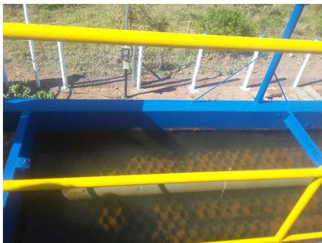
Figura 16. Decantador – ETA de Carapebus/RJ. Fonte: Equipe Técnica (2019).
