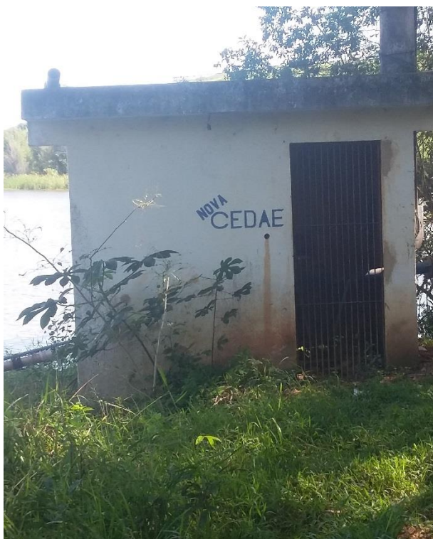
Figura 9. Casa de bomba da estação elevatória da represa da Maricota. Fonte: Equipe Técnica (2019).
