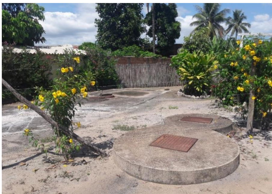
Figura 26. Caixas de acúmulo de esgoto localizadas à margem do córrego da Maricota no bairro Praça Cordeiro, próximo à Rua Carlito Pinto da Silva. Fonte: Equipe Técnica (2019).
