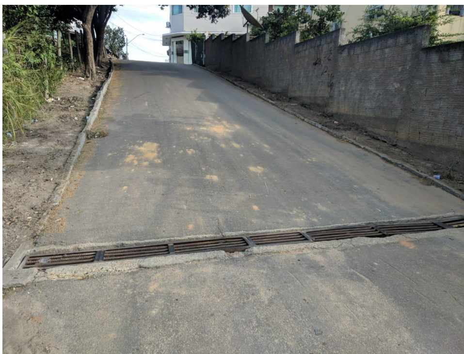
Figura 64. Registro da estrutura tipo grelha, amplamente utilizada na microdrenagem na cidade de Carapebus/RJ. Fonte: Equipe Técnica, 2019.
