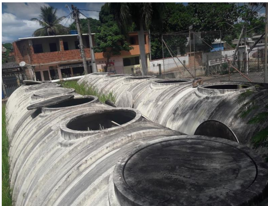
Figura 37. Estado dos tanques da ETE Ubás, com vegetação crescendo dentro e fora dos tanques. Fonte: Equipe Técnica (2019).
