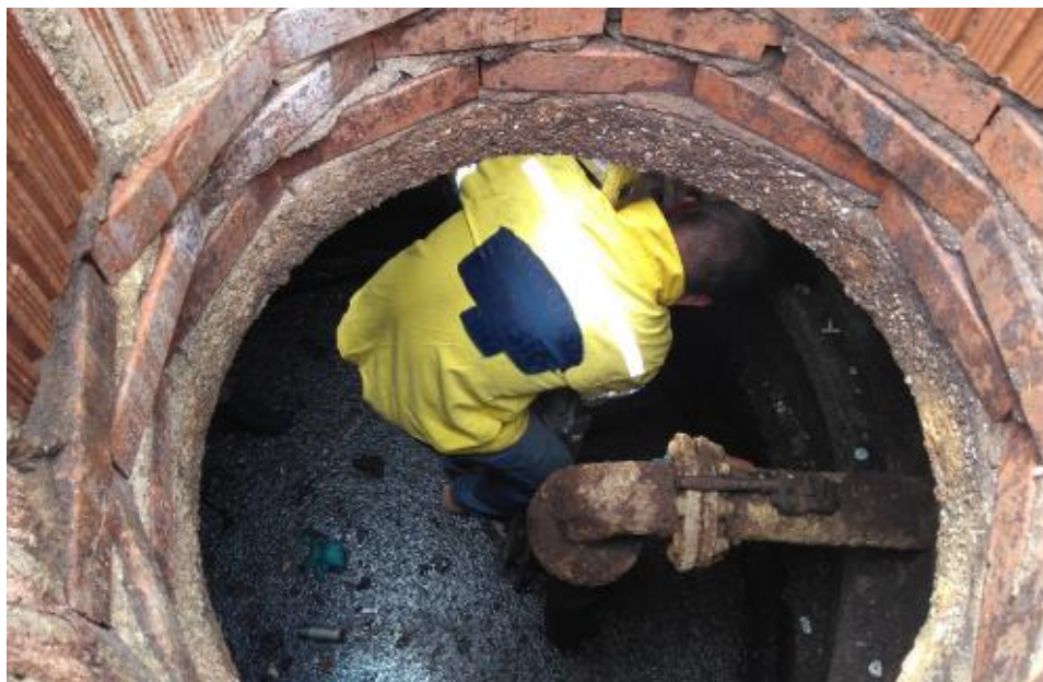
Figura 28. Vista do poço de visita localizado próximo a ETE do Centro. Fonte: José Ricardo Maia.
