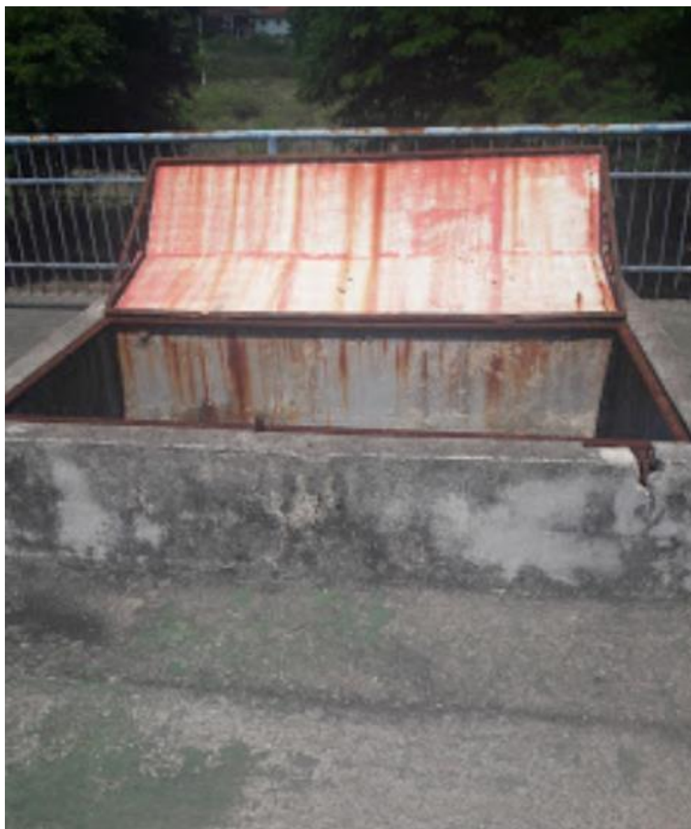
Figura 33. Deterioração do concreto e presença de ferrugem nas tampas dos tanques da ETE do Centro. Fonte: Equipe Técnica (2019).
