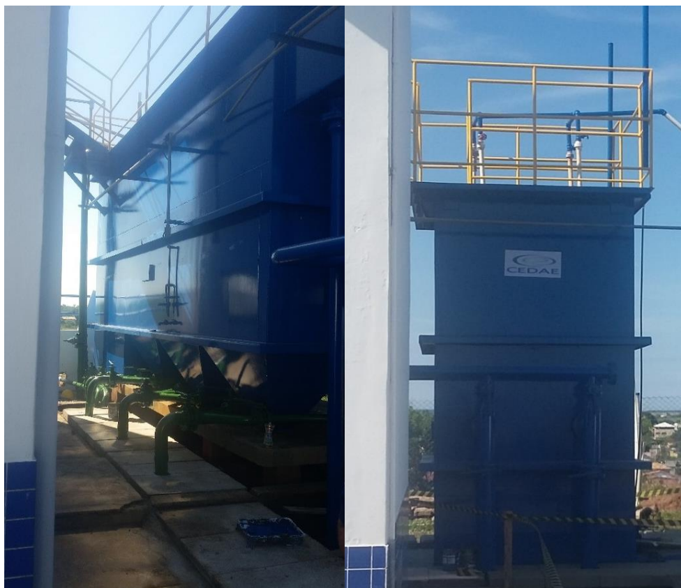
Figura 12. Registros da Estação de Tratamento de Água de Carapebus/RJ. Fonte: Equipe Técnica (2019).
