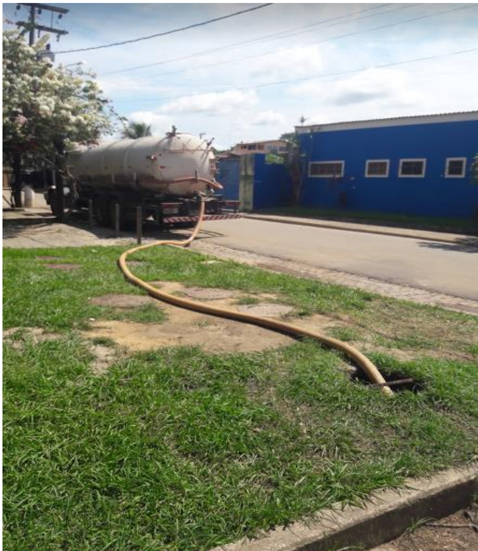
Figura 27. Caminhão limpa fossa despejando esgoto no PV localizado próximo a ETE do Centro de Carapebus. Fonte: Equipe Técnica (2019).
