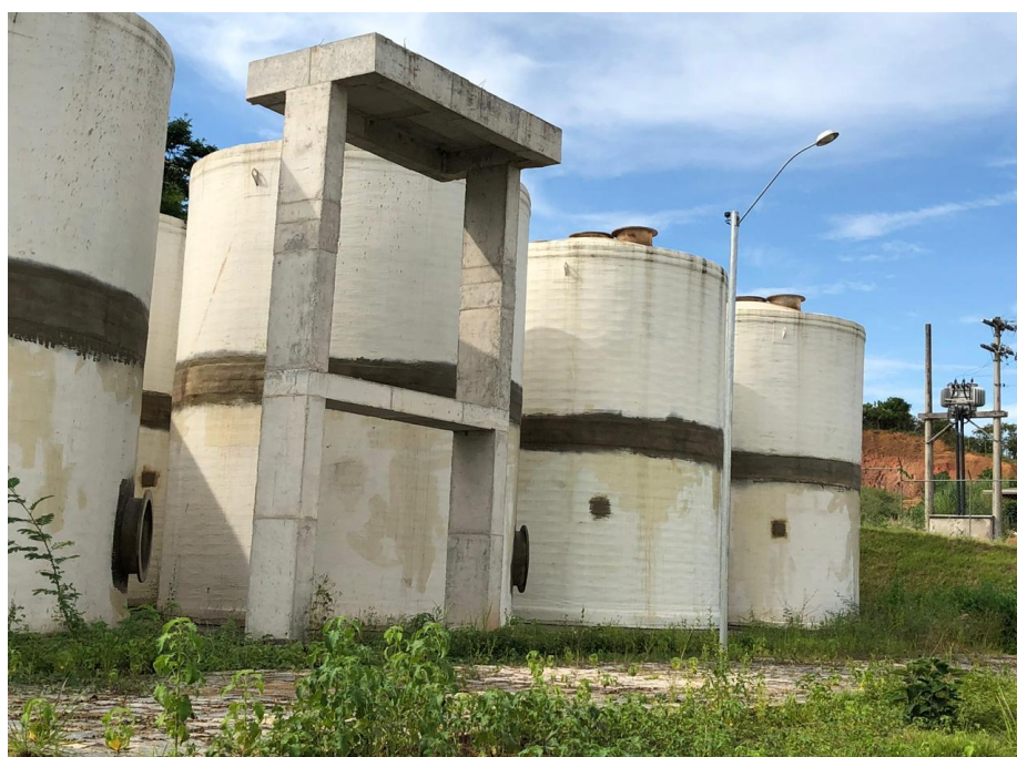
Figura 18. Vista lateral dos Reatores Anaeróbios de Fluxo Ascendente (UASB) da ETE de Miracema/RJ. Fonte: Arquivo pessoal, 2020.
