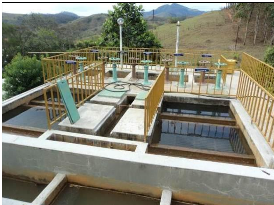
Figura 14 – Estação de tratamento de água Fonte: DRZ - Gestão Ambiental
