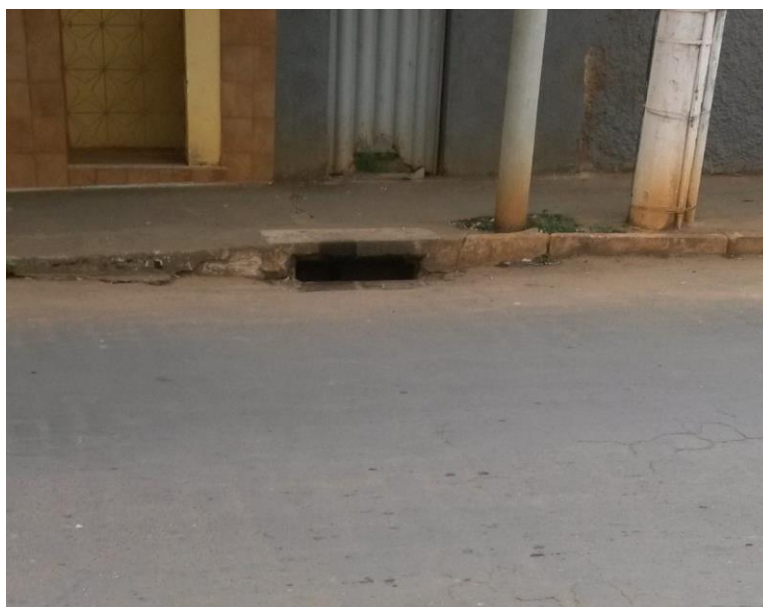
Figura 48 - Estrutura de captação do tipo lateral no Distrito Sede Fonte: DRZ – Gestão Ambiental
