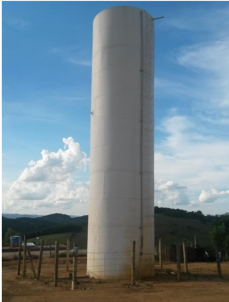
Figura 26 - Reservatório apoiado (100m 3 ). Fonte: DRZ-Gestão Ambiental.
