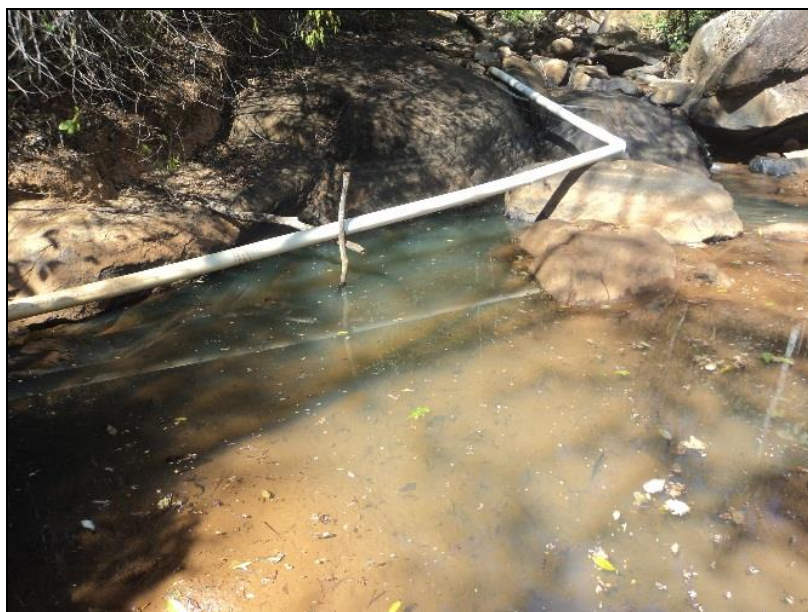
Figura 7 - Captação de água bruta em Astolfo Dutra – MG.
