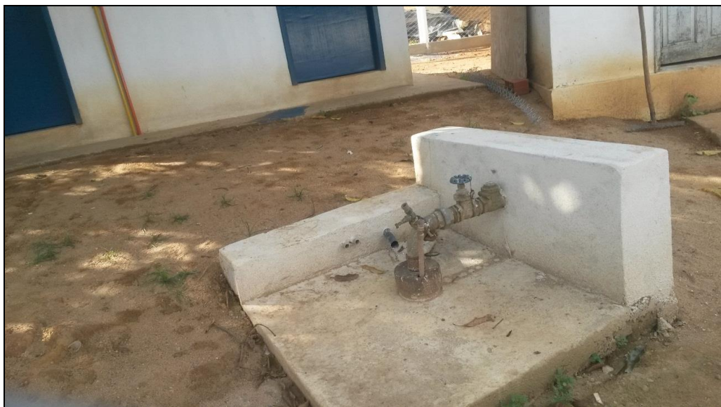
Figura 31 - Poço 02 Fonte: DRZ-Gestão Ambiental
