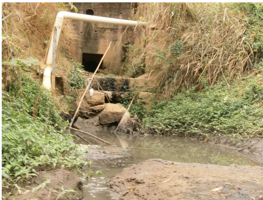
Figura 40 – Emissário de esgoto e drenagem. Fonte: DRZ - Gestão Ambiental.
