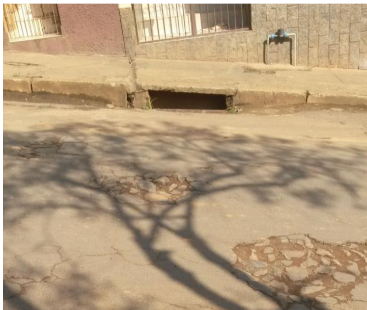
Figura 52 - Estrutura de captação do tipo lateral no Distrito de Sobral Pinto Fonte: DRZ – Gestão Ambiental
