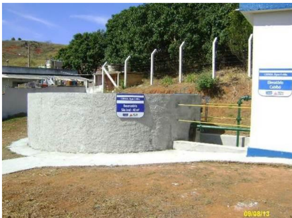
Figura 21– Reservatório São José (40m 3 ) Fonte: DRZ - Gestão Ambiental
