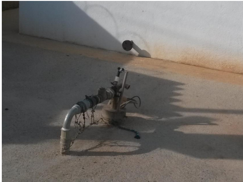
Figura 23 – Poço 01. Fonte: DRZ – Gestão Ambiental
