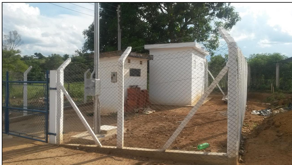
Figura 32 - Poço 02 Fonte: DRZ-Gestão Ambiental
