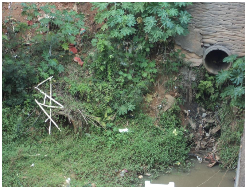
Figura 55 - Lançamento de efluente de esgoto doméstico em rede de microdrenagem Fonte: DRZ – Gestão Ambiental
