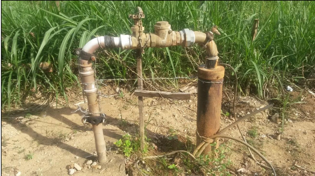
Figura 30 - Poço 01 Fonte: DRZ-Gestão Ambiental
