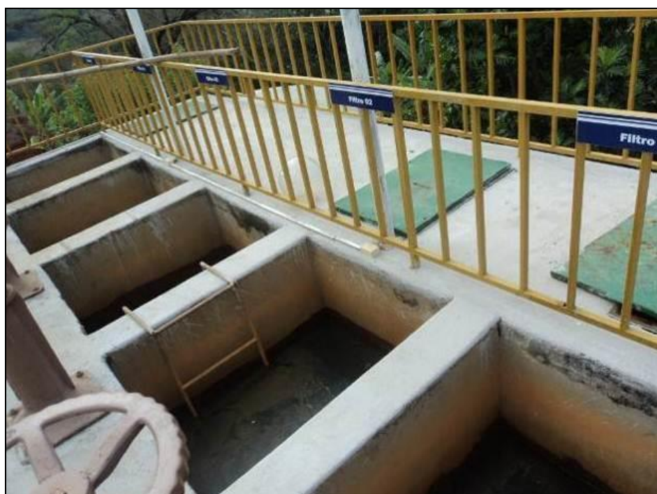
Figura 15 – Filtros - Estação de tratamento de água Fonte: DRZ - Gestão Ambiental
