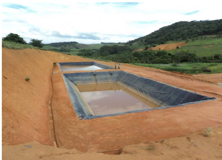
Figura 65 - Lagoas tratamento da Central de Tratamento de Leopoldina da Empresa União Recicláveis
