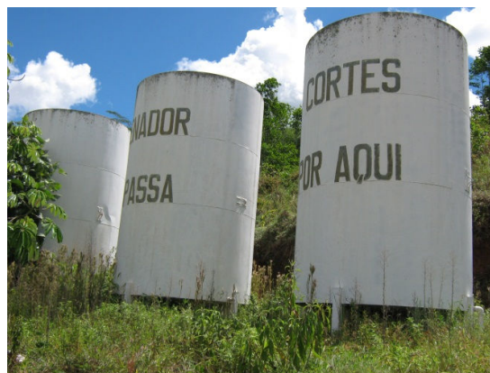
Figura 36 – Conjunto de reservatório vista 2.
