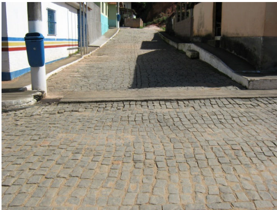
Figura 51 – Inexistência de sarjeta vista 1.
