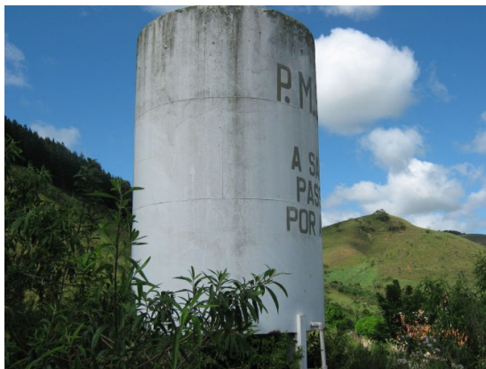
Figura 39 – Reservatório bairro Novo Horizonte vista 1.
