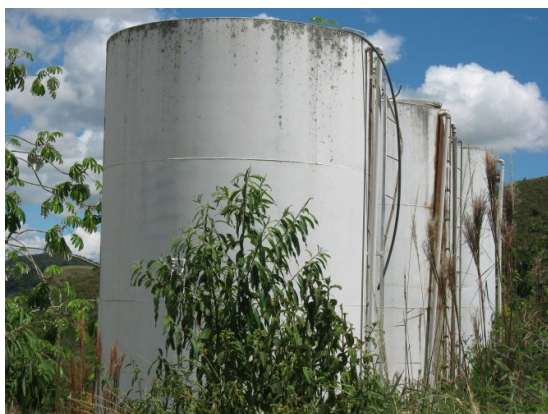
Figura 35 – Conjunto de reservatório vista 1.
