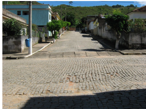
Figura 52 – Inexistência de sarjeta vista 2.
