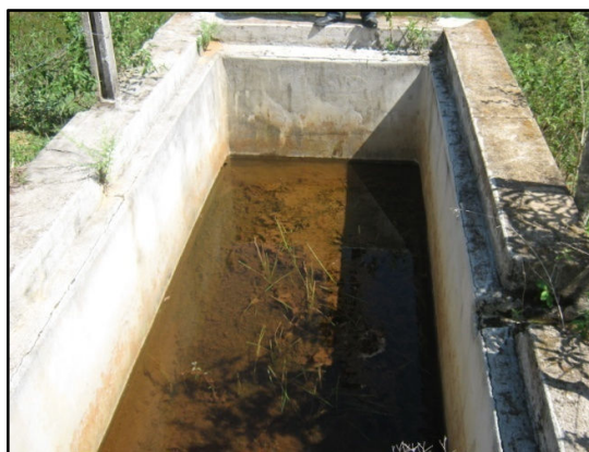
Figura 25– Vista da Caixa
