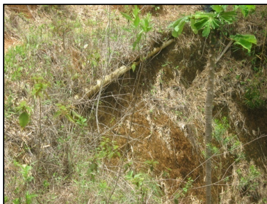
Figura 17– Tubo enterrado em condições precárias
