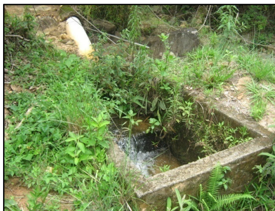
Figura 15– Caixa de captação
