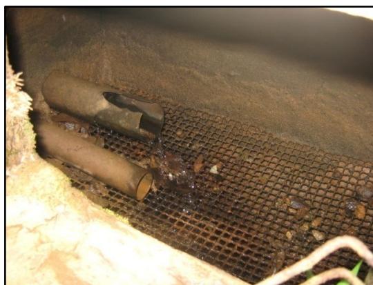
Figura 23– Detalhe da captação
