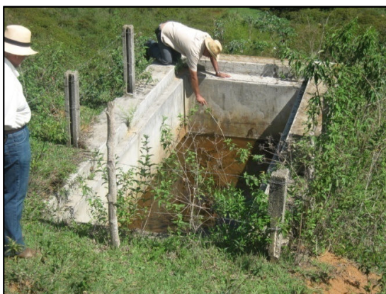
Figura 24– Vista da Caixa
