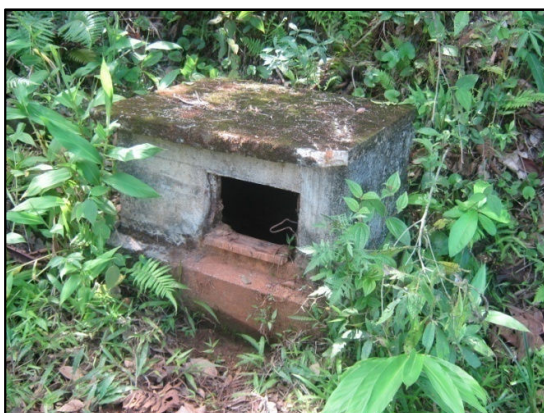
Figura 22– Caixa de captação
