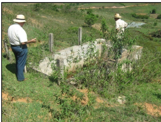
Figura 26– Vista da Caixa
