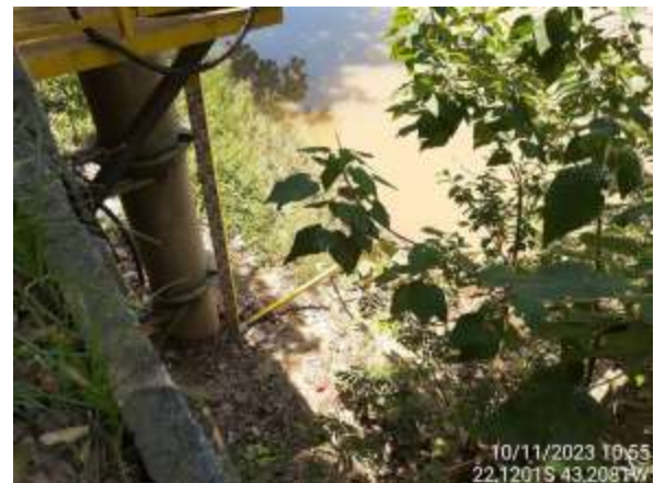
Figura 4.171. RJ09 - Régua limnimétrica.
