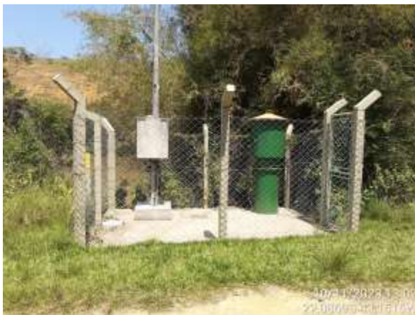
Figura 4.198. RJ13 - Estação de monitoramento.
