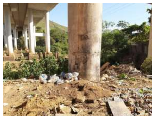
Figura 4.36. RJ10 - Acesso comprometido.
