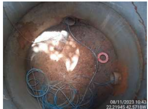
Figura 4.209. RJ15 - Condição interna.
