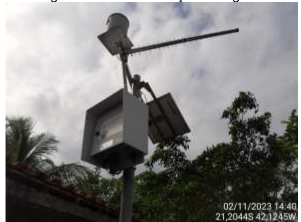
Figura 4.259. RJ28 - Vista externa da PCD.
