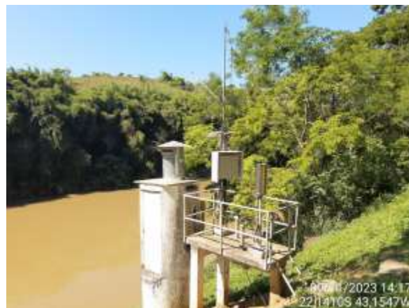
Figura 4.183. RJ11 - Estação de monitoramento.
