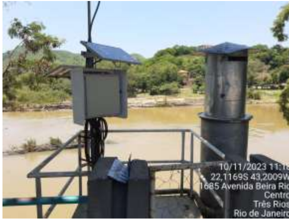
Figura 4.160. RJ09 - Vista externa da PCD.
