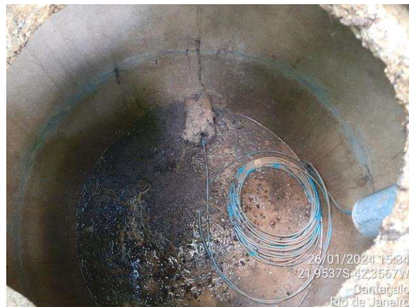
Figura 2.32. RJ16 - Condição interna do gabinete.
