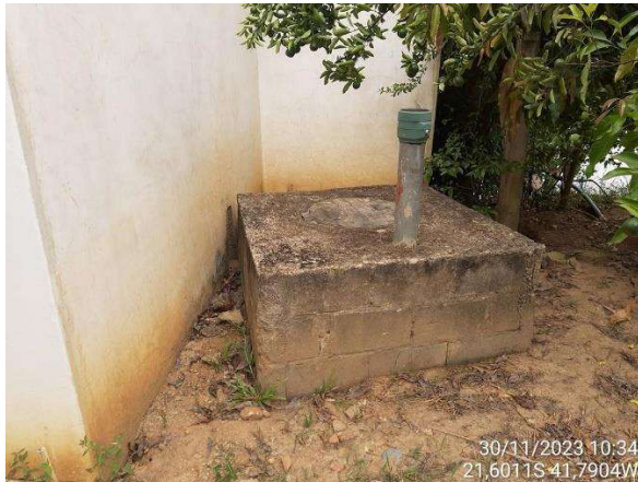
Figura 2.40. RJ20 – Estrutura externa da estação de monitoramento de qualidade.
