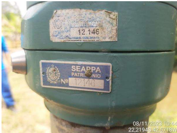
Figura 2.7. RJ15 – Patrimônio da estação de monitoramento de qualidade da água.
