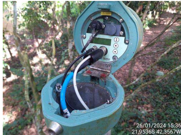
Figura 2.34. RJ16 – Condição interna da PCD.
