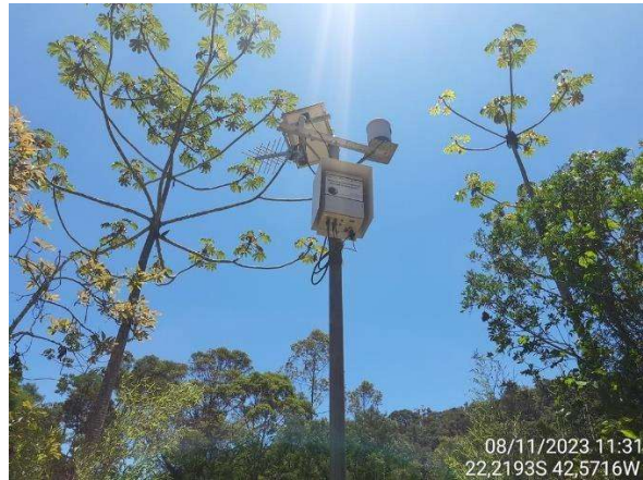
Figura 2.23. RJ15 – Vista externa da estação telemétrica existente no local.
