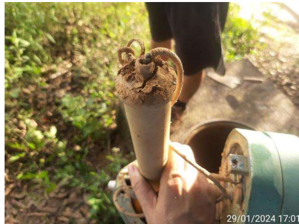
Figura 2.53. RJ25 – Componente interno da PCD com sedimentos.
