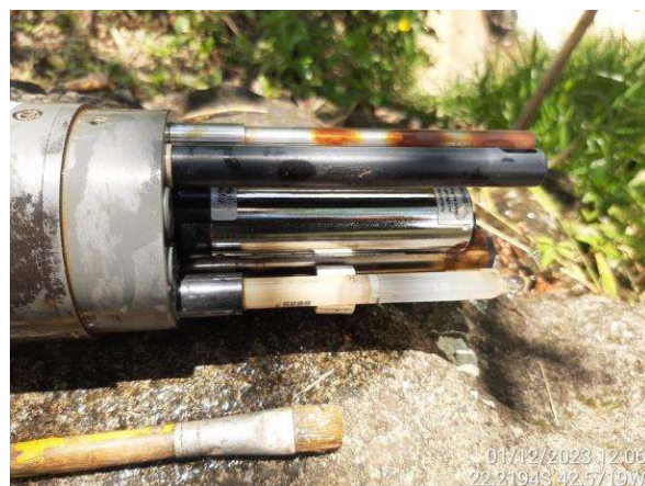
Figura 2.14. RJ15 - Sensores após da limpeza.
