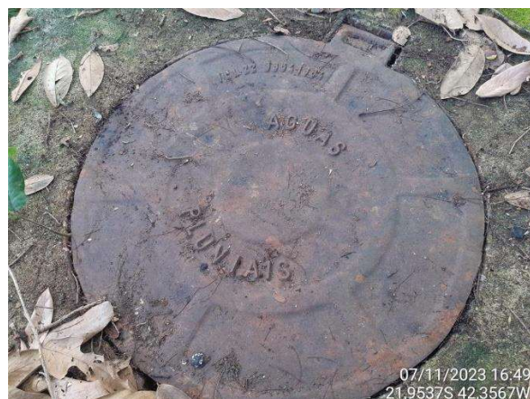
Figura 2.30. RJ16 - Tampa do gabinete da estação.
