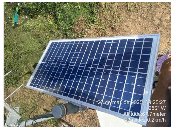
Figura 2.10 - Limpeza da placa solar.
