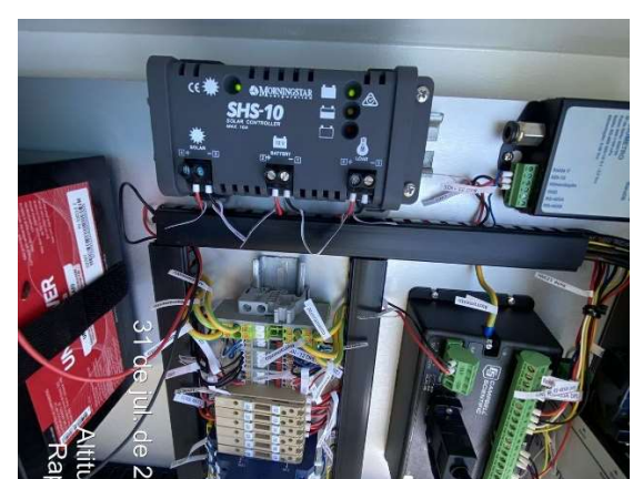
Figura 2.4 - Vista interna da PCD.
