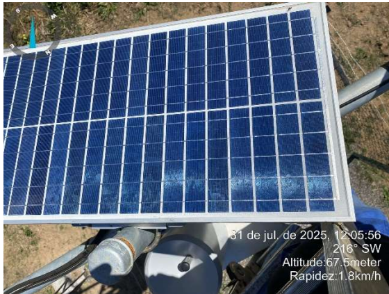
Figura 2.5 - Limpeza da placa solar
