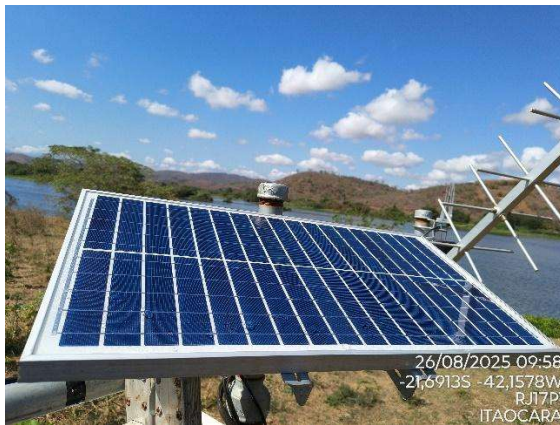
Figura 2.5 - Limpeza da placa solar
