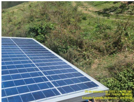
Figura 2.5 - Limpeza da placa solar
