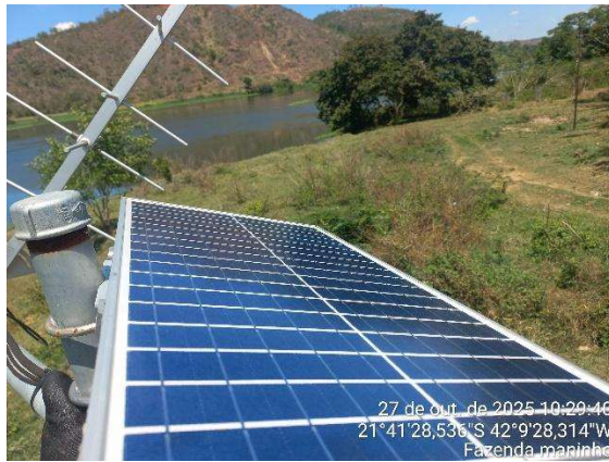
Figura 2.5 - Limpeza da placa solar
