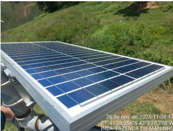
Figura 2.7 - Limpeza da placa solar
