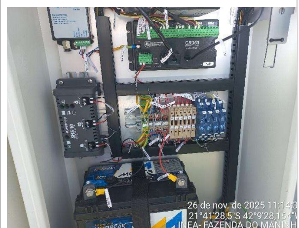
Figura 2.4 - Vista interna da PCD.
