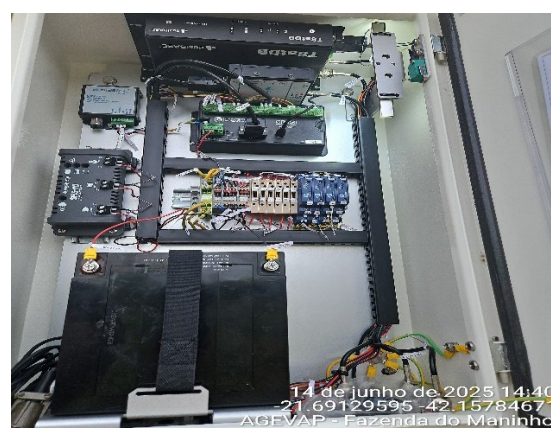
Figura 2.4 - Vista interna da PCD.
