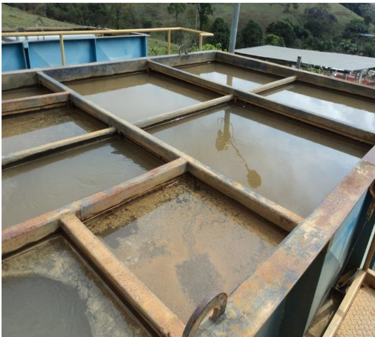
Figura 13 - Estação de Tratamento de Água no distrito Sede - COPASA
