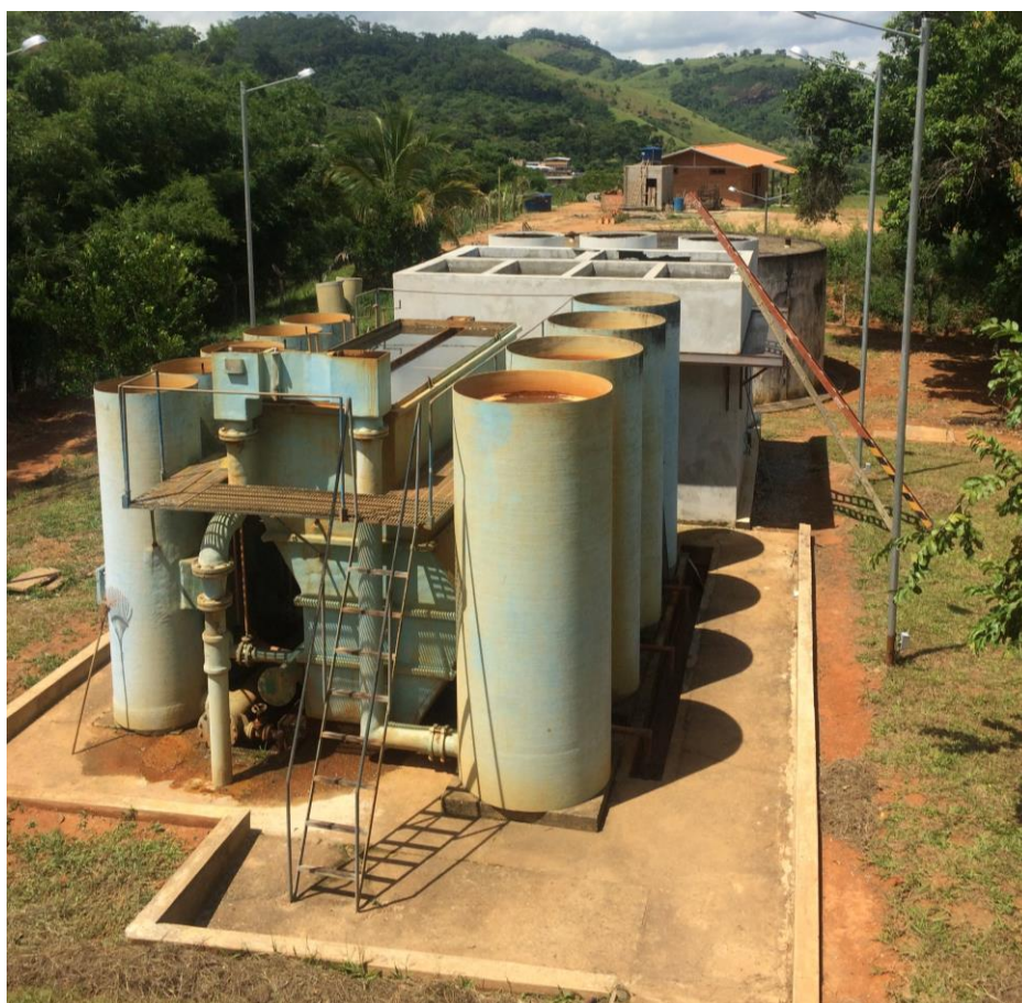
Figura 13 – Estação de tratamento de água Fonte: DRZ - Gestão Ambiental
