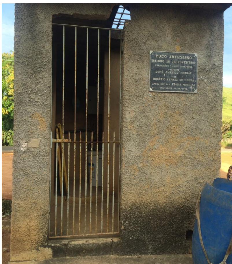
Figura 8 – Captação subterrânea 2 – XV de Novembro Fonte: DRZ – Gestão Ambiental
