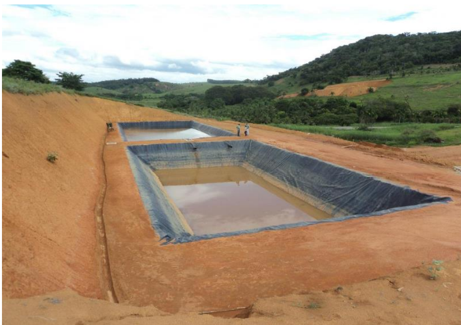
Figura 41 – Lagoas de tratamento da Central de Tratamento de Leopoldina da Empresa União Recicláveis
