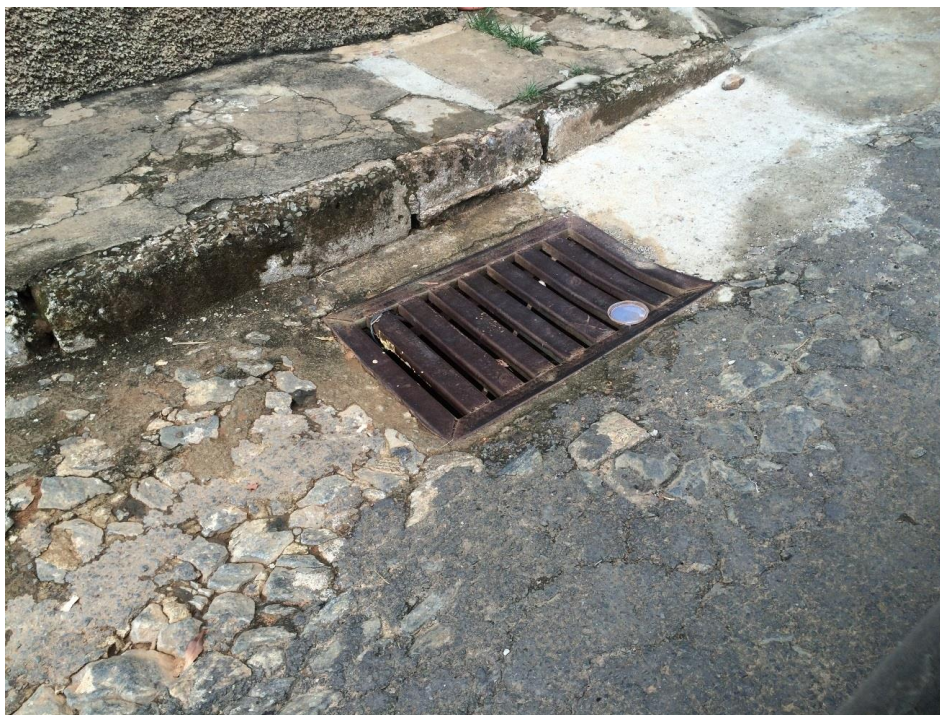
Figura 30 - Estrutura de captação do tipo grelha
