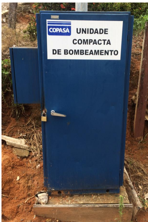
Figura 10 - Booster do sistema de abastecimento de água do Município de Itamarati de Minas Fonte: DRZ – Gestão Ambiental
