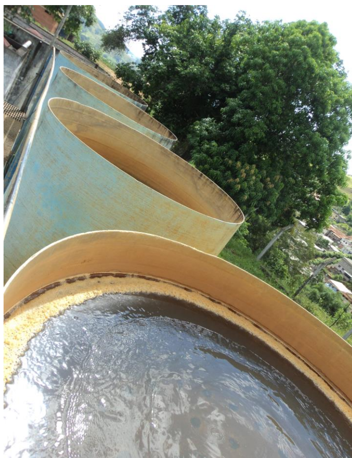
Figura 15 – Flocculador – ETA antiga Fonte: DRZ - Gestão Ambiental
