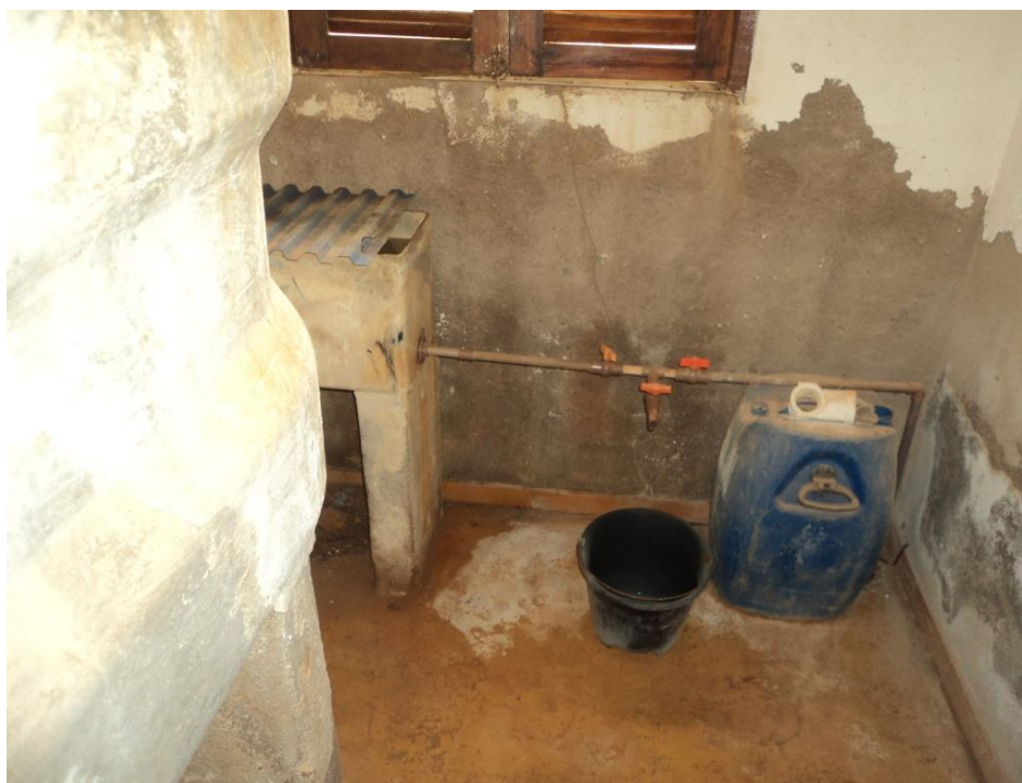
Figura 20 - Sala de cloração - adição de cloro Fonte: DRZ - Gestão Ambiental
