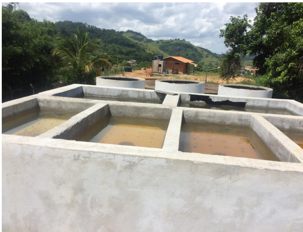
Figura 16 – Flocculador, decantador e filtros – ETA nova Fonte: DRZ - Gestão Ambiental
