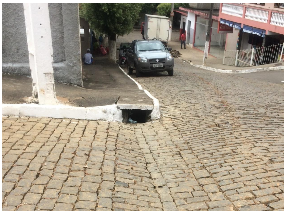
Figura 31 - Estrutura de captação do tipo lateral Fonte: DRZ – Gestão Ambiental
