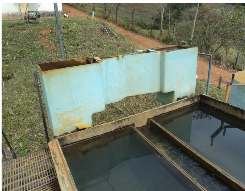
Figura 14– Calha Parschall - ETA Antiga Fonte: DRZ - Gestão Ambiental
