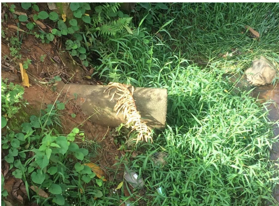
Figura 34 - Lançamento de efluente de esgoto doméstico em rede de microdrenagem Fonte: DRZ – Gestão Ambiental
