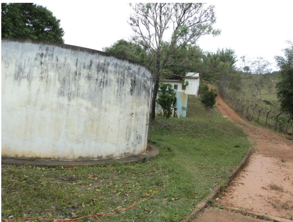
Figura 12 – Estação de tratamento de água – Todos os componentes Fonte: DRZ - Gestão Ambiental
