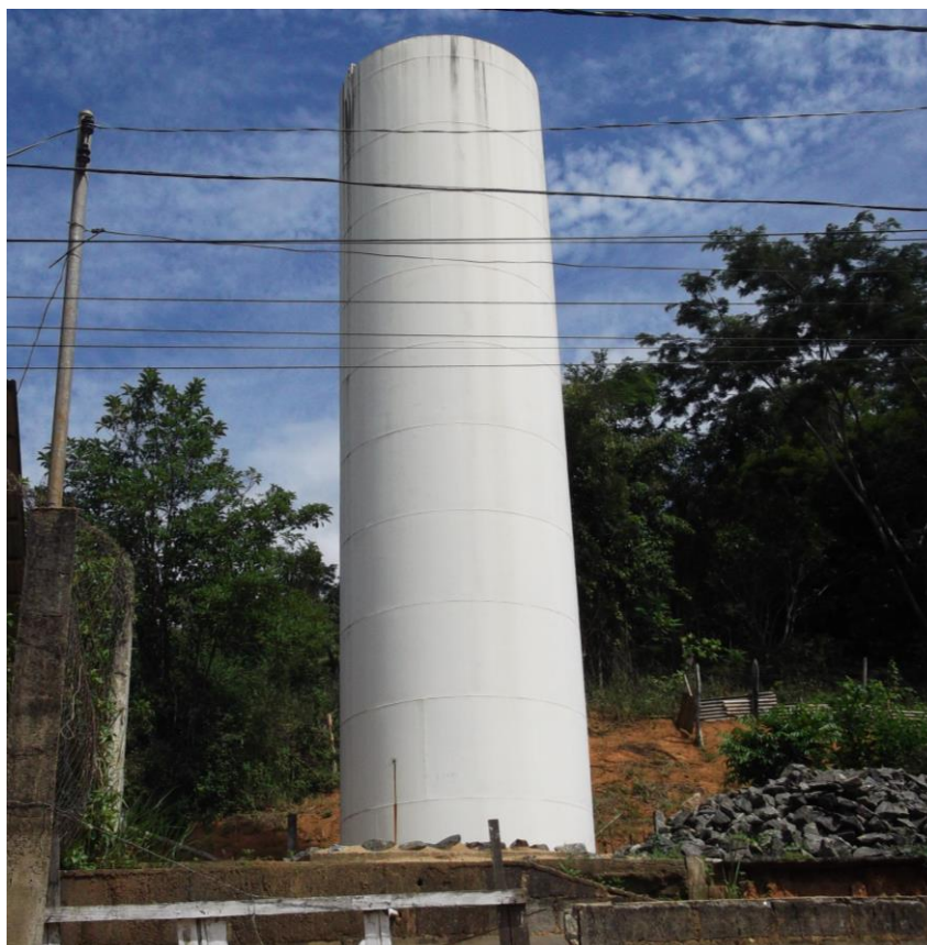
Figura 23 – Reservatório elevado de 100 m 3 do Bairro Sol Nascente Fonte: DRZ - Gestão Ambiental
