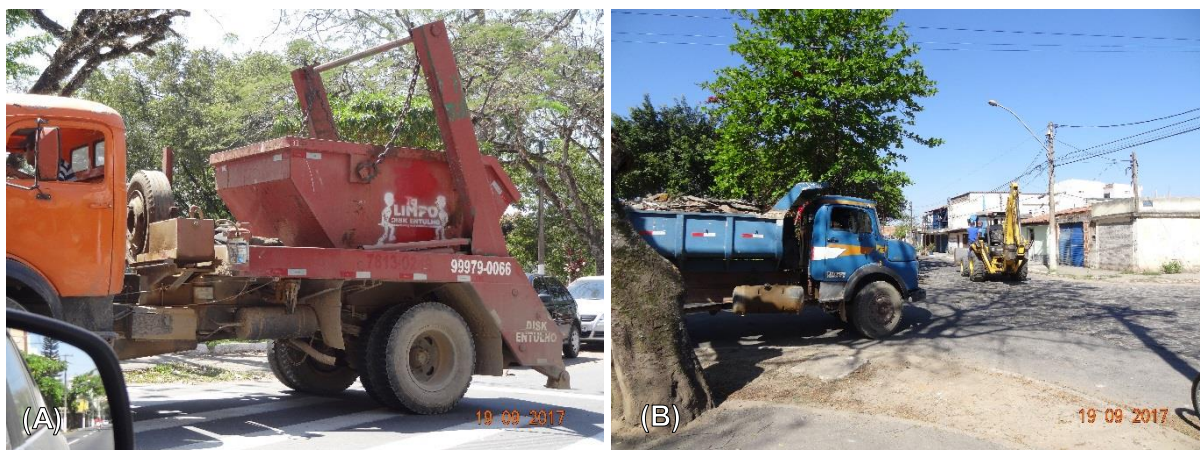
Figura 78 – Coleta e transporte dos RCC: (A) Caminhão tipo “Brooks” a empresa especializada, transportando caçamba de entulho; (B) Caminhão em mutirão de limpeza realizando a coleta e transporte de RCC na Av. do Canal Norte no Bairro Cidade Alegria.
