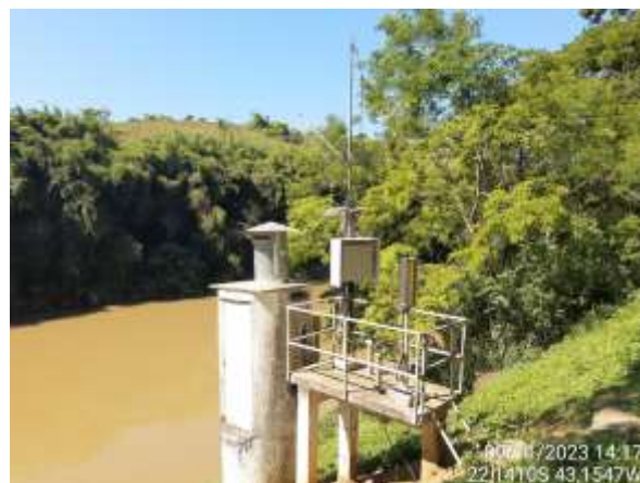
Figura 4.183. RJ11 - Estação de monitoramento.
