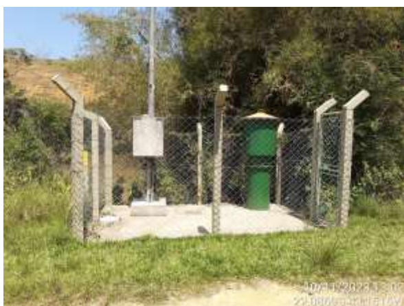
Figura 4.198. RJ13 - Estação de monitoramento.
