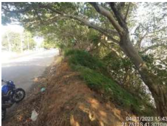
Figura 4.83. RJ24 - Dificuldade de acesso.
