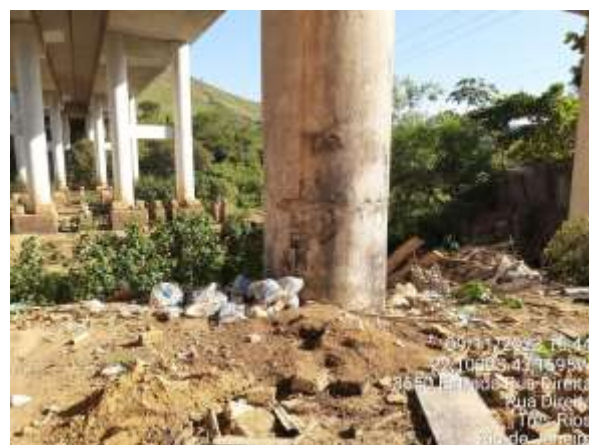
Figura 4.36. RJ10 - Acesso comprometido.
