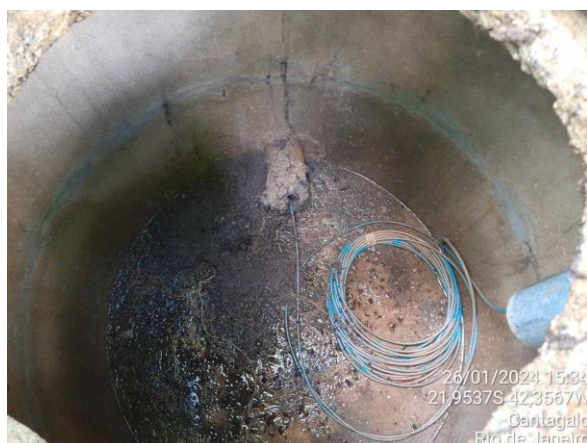
Figura 2.32. RJ16 - Condição interna do gabinete.
