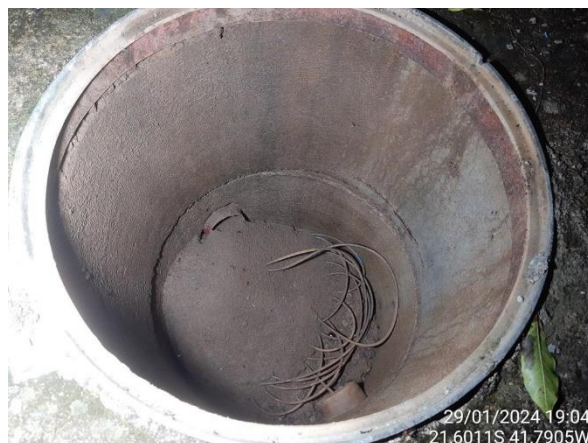
Figura 2.43. RJ20 – Gabinete da estação.
