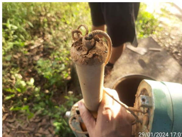
Figura 2.53. RJ25 – Componente interno da PCD com sedimentos.
