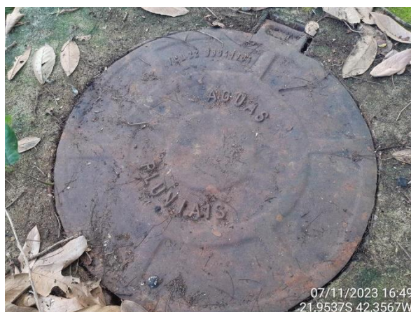
Figura 2.30. RJ16 - Tampa do gabinete da estação.
