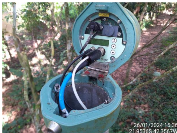
Figura 2.34. RJ16 – Condição interna da PCD.
