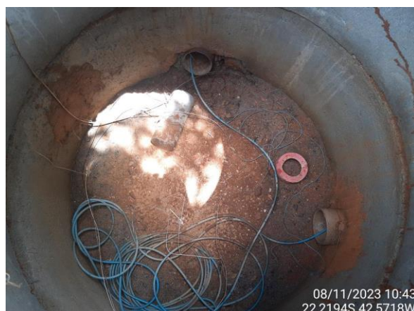
Figura 2.6. RJ15 - Condição interna do gabinete.
